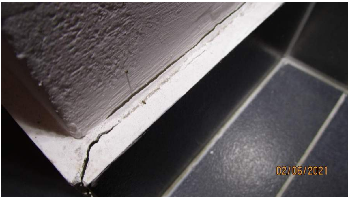
105) sokl nedrží na podkladu
