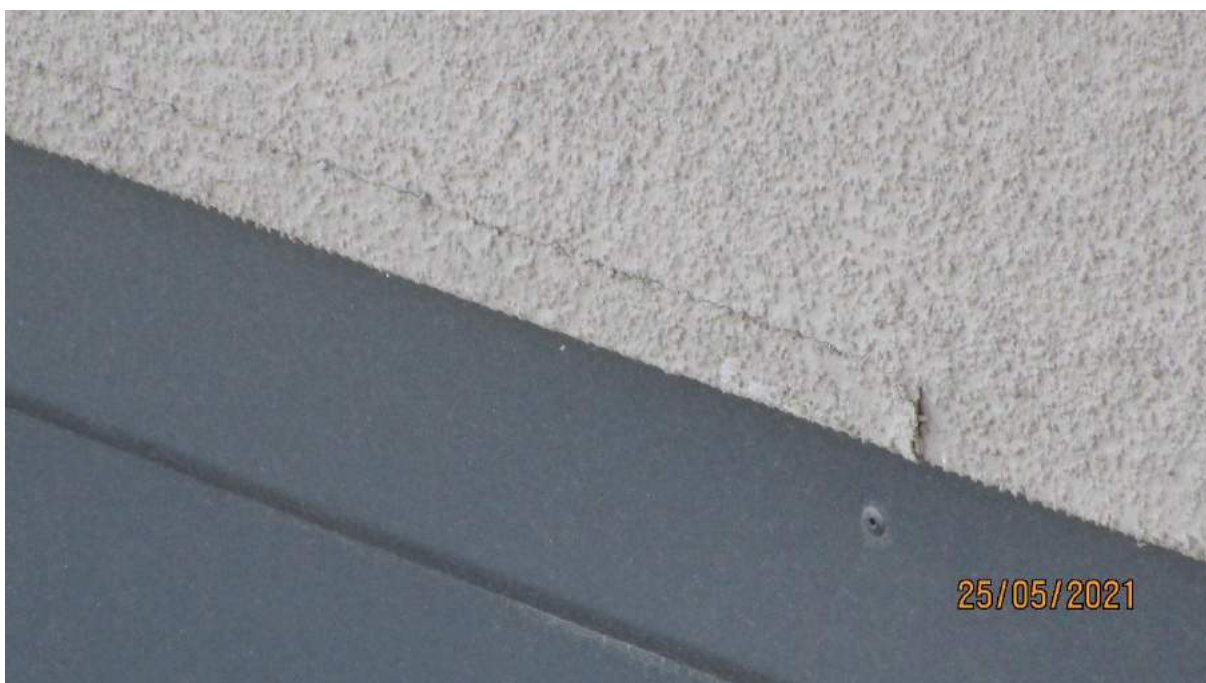
74) prasklina nad spodním okrajem fasády
