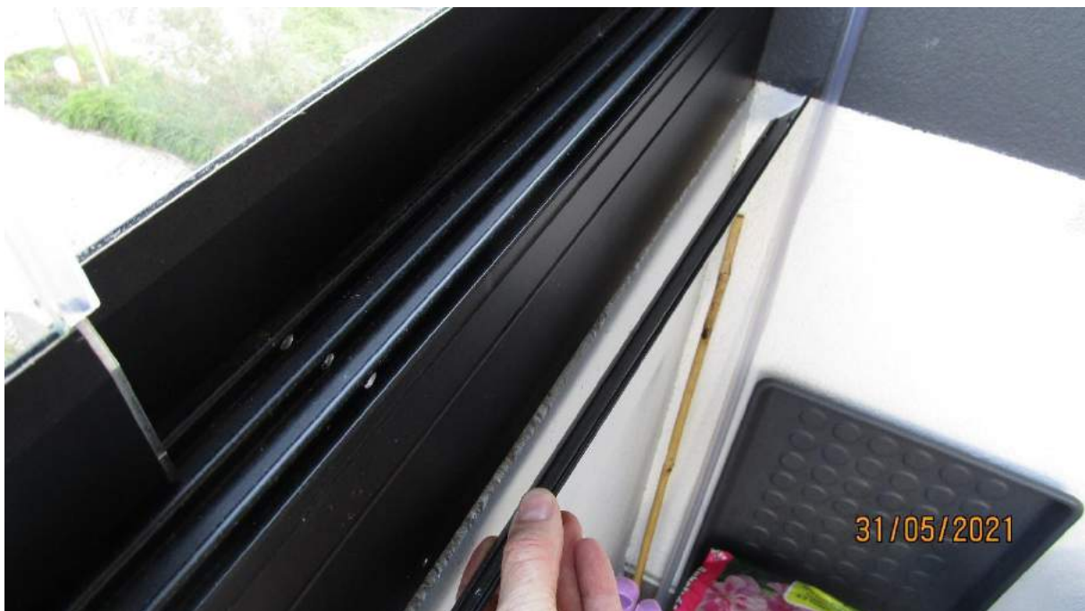
123) lišta nedrží na rámu
