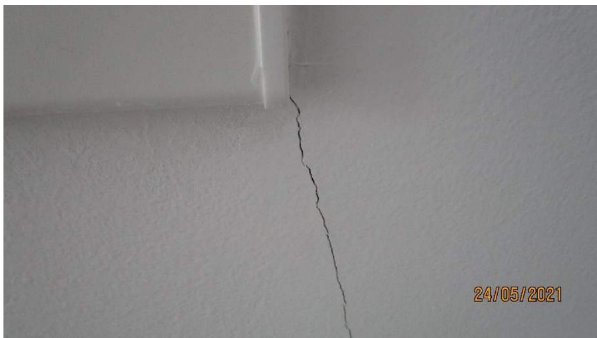
43) prasklina v obvodové stěně
