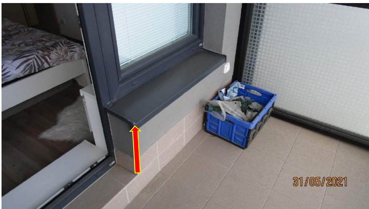
131) parapet nedrží na podkladu
