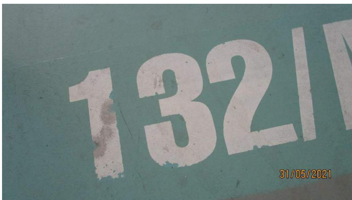
7) vodorovné dopravní značení se odlupuje..... viz další detaily
