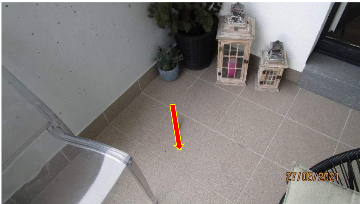
98) dlažba nedrží na podkladu – při poklepu zní dutě
