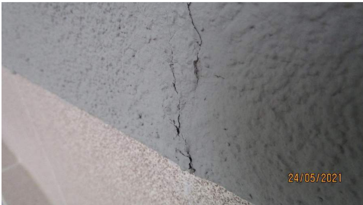
47) prasklina ve fasádě
