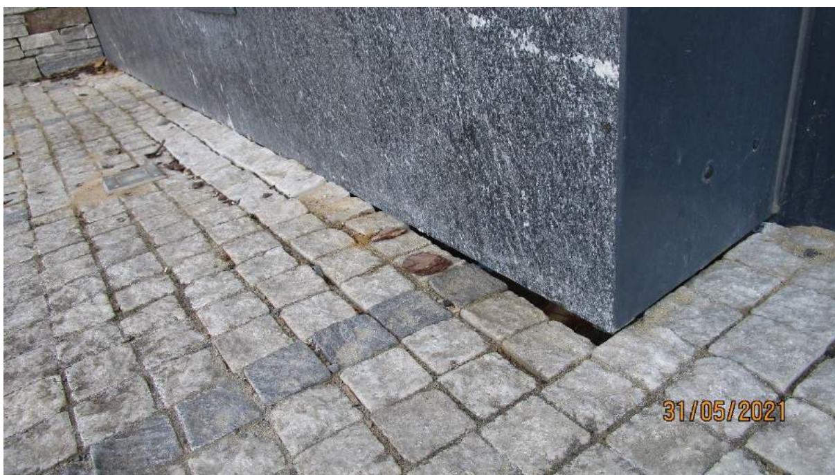
21) nezapravená větší spára mezi fasádou a chodníkem
