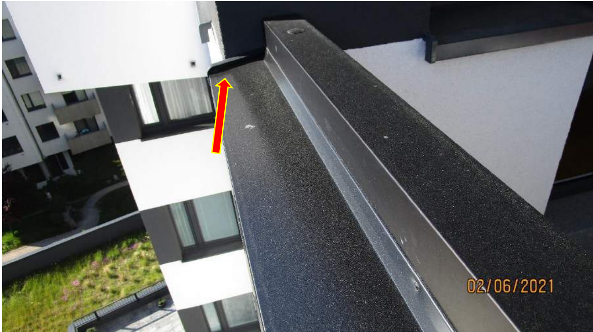
139) parapet nedrží na podkladu
