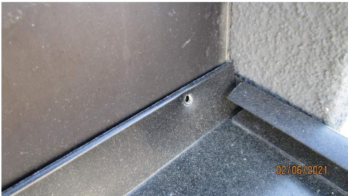
140) chybí nýt – parapet nedrží na podkladu
