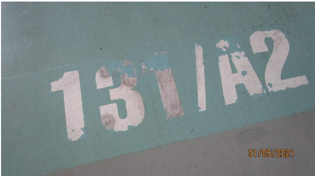
6) vodorovné dopravní značení se odlupuje
