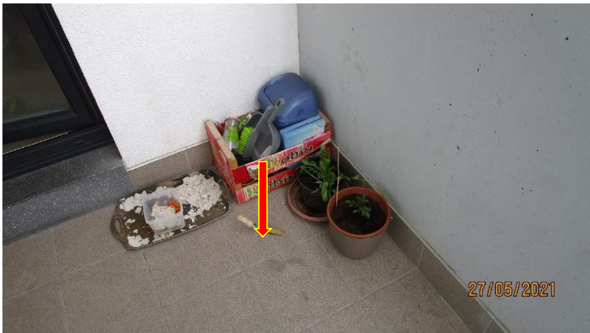
91) dlažba nadrží na podkladu – při poklepu zní dutě
