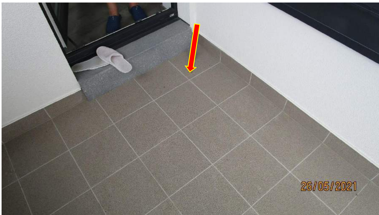
79) dlaždice nadrží na podkladu – při poklepu vydává dutý zvuk
