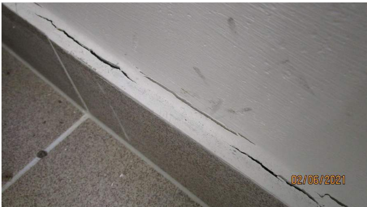
27) sokl nedrží na podkladu – místnost UPS
