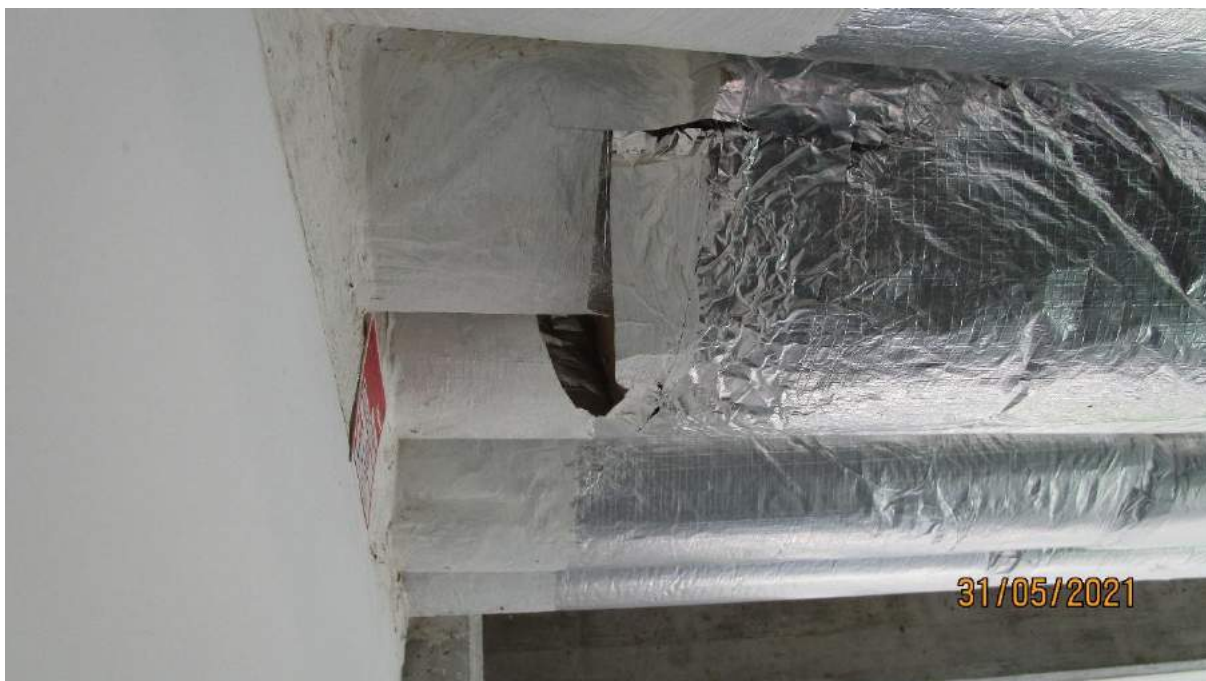
3) izolace potrubí není soudržná – stání č. 124
