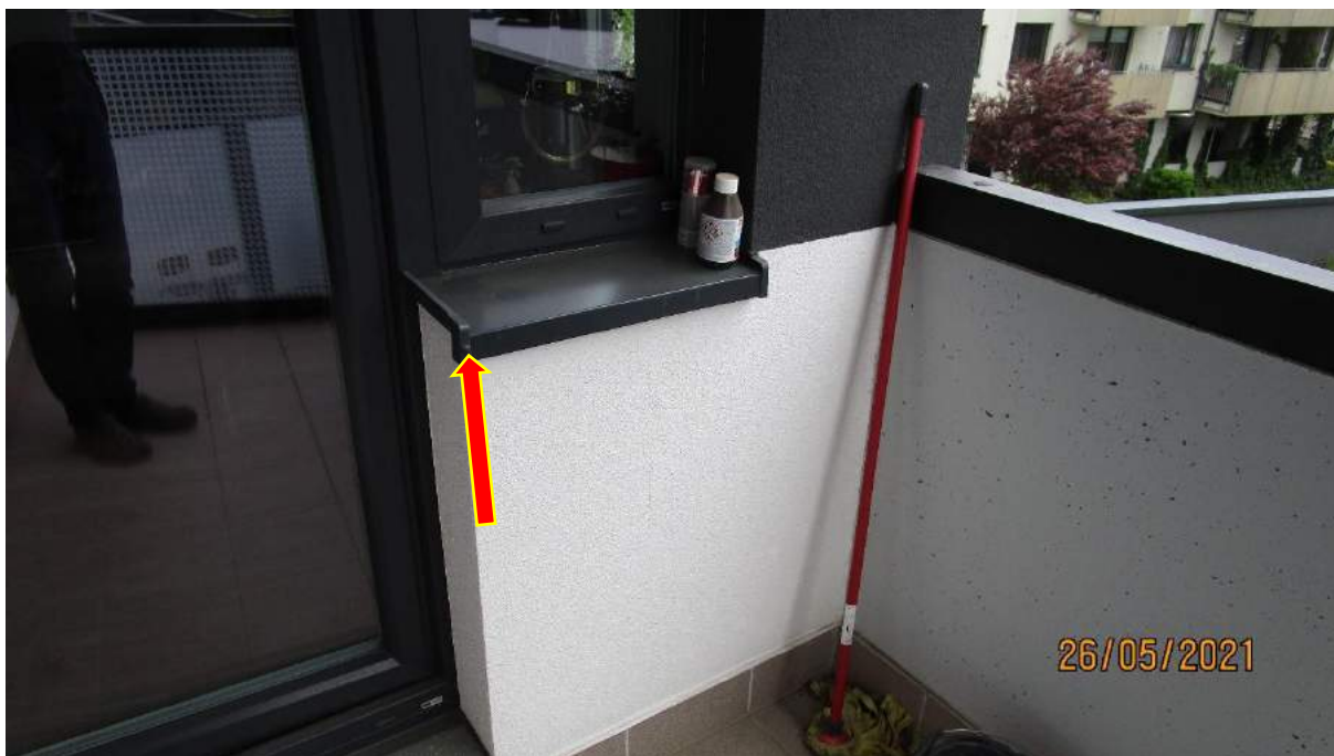
60) parapet nedrží na podkladu
