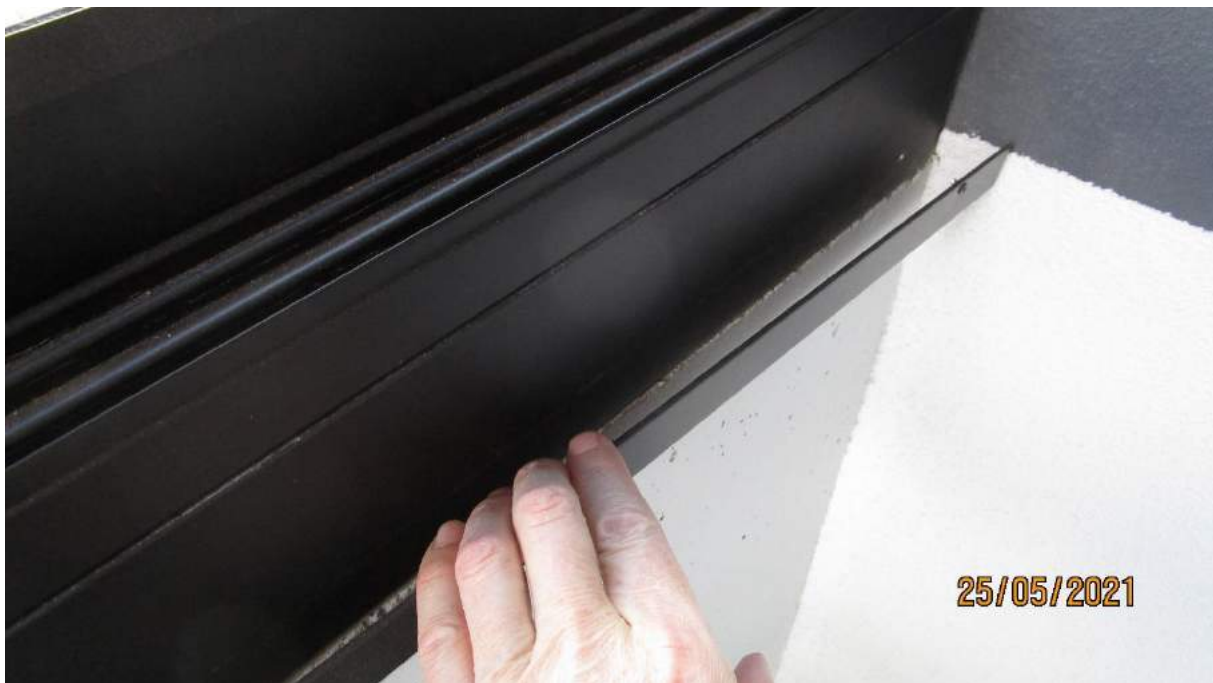
52) lišta nedrží na rámu
