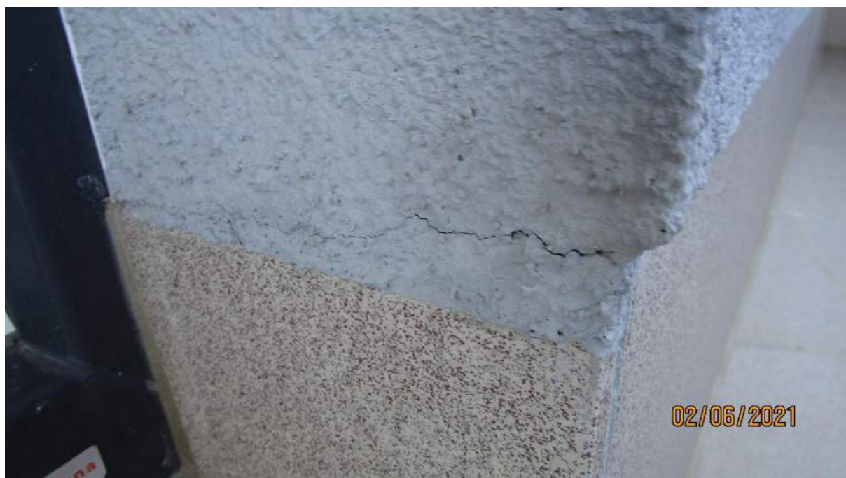
150) prasklina nad soklem
