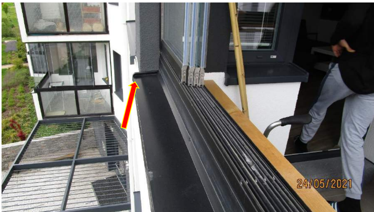
54) parapet nedrží na podkladu
