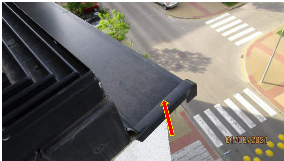
134) parapet nedrží na podkladu
