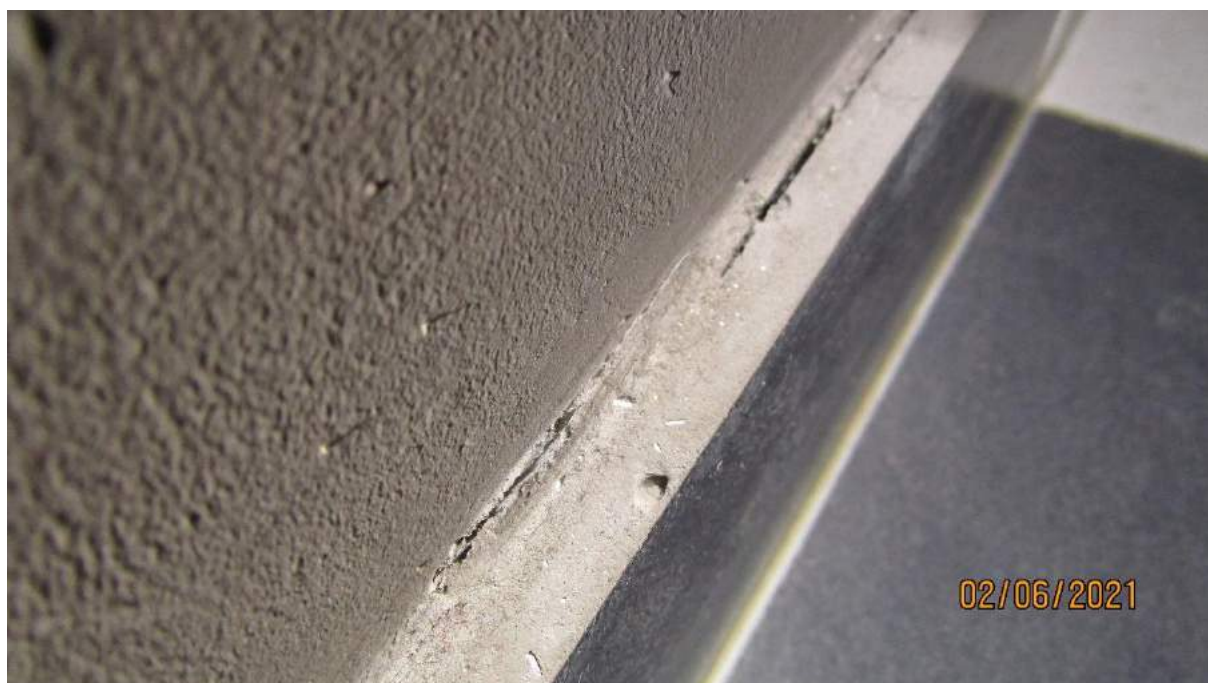
31) sokl nedrží na podkladu
