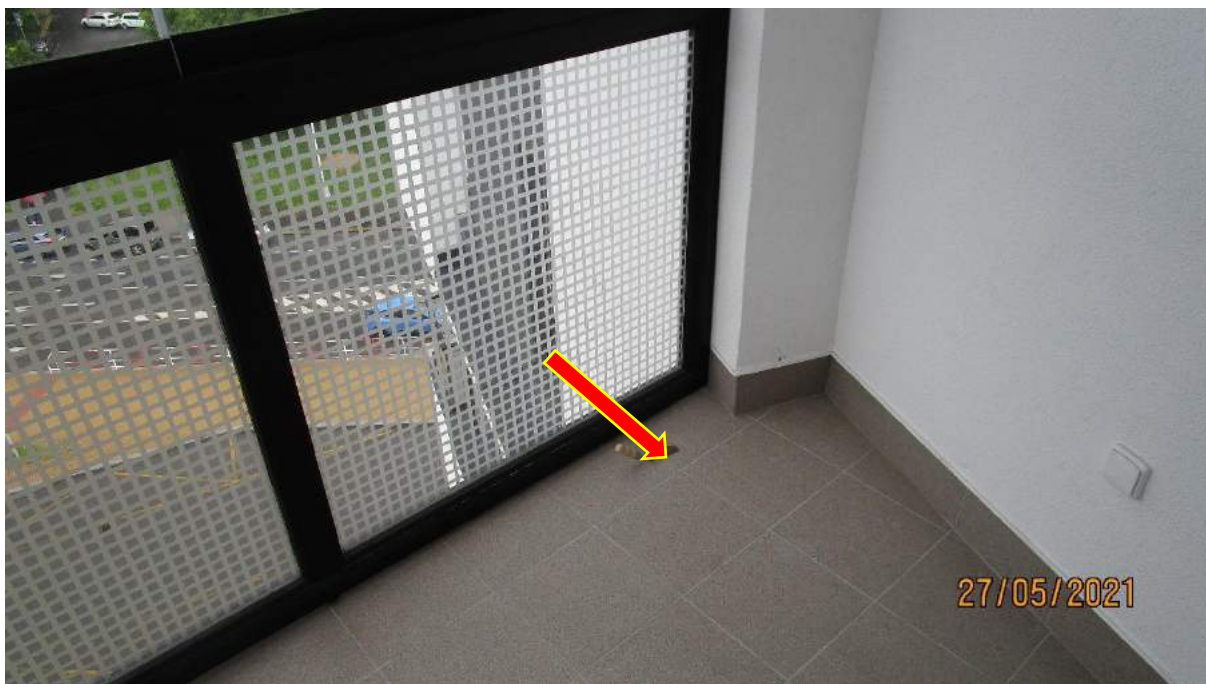
89) dlažba nedrží na podkladu – při poklepu zní dutě
