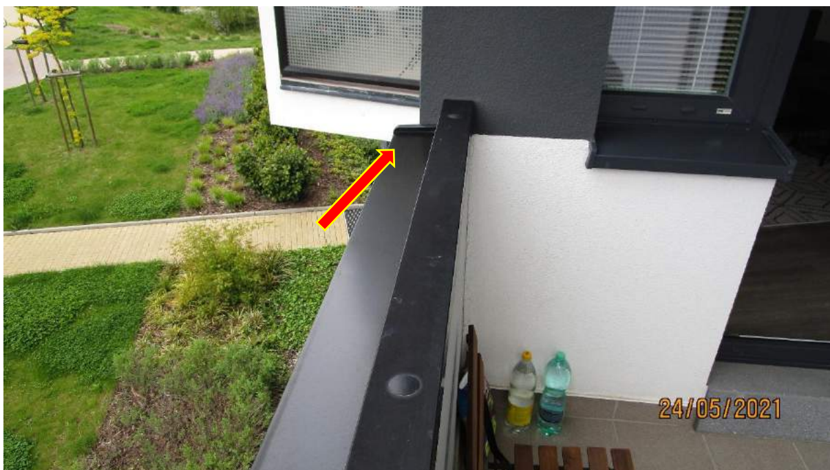
50) parapet nedrží na podkladu
