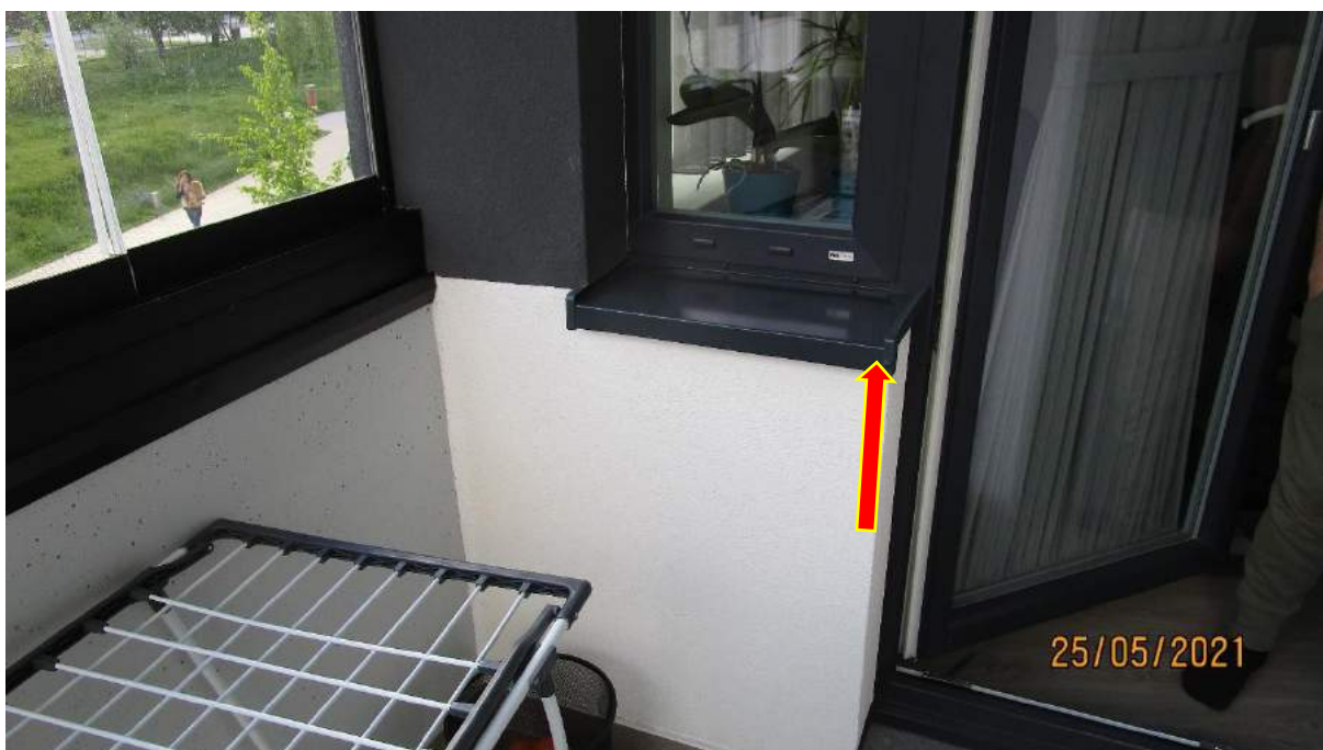
51) parapet nedrží na podkladu
