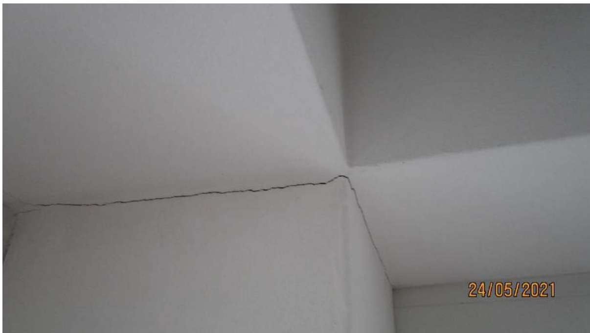
44) praskliny v rohu místnosti pod stropem
