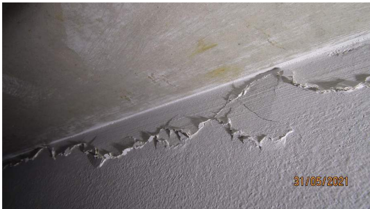
14) omítka nedrží na podkladu v prasklině - stání č. 251
