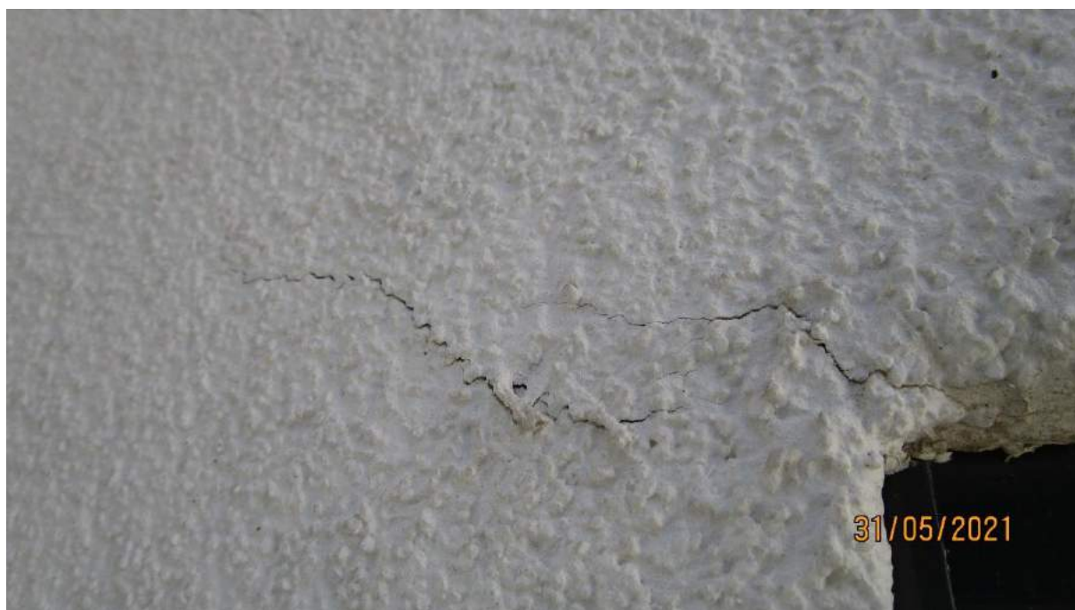
116) prasklina ve fasádě
