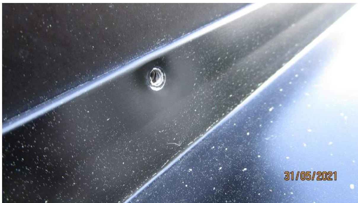
115) chybí nýty - parapet nedrží na podkladu
