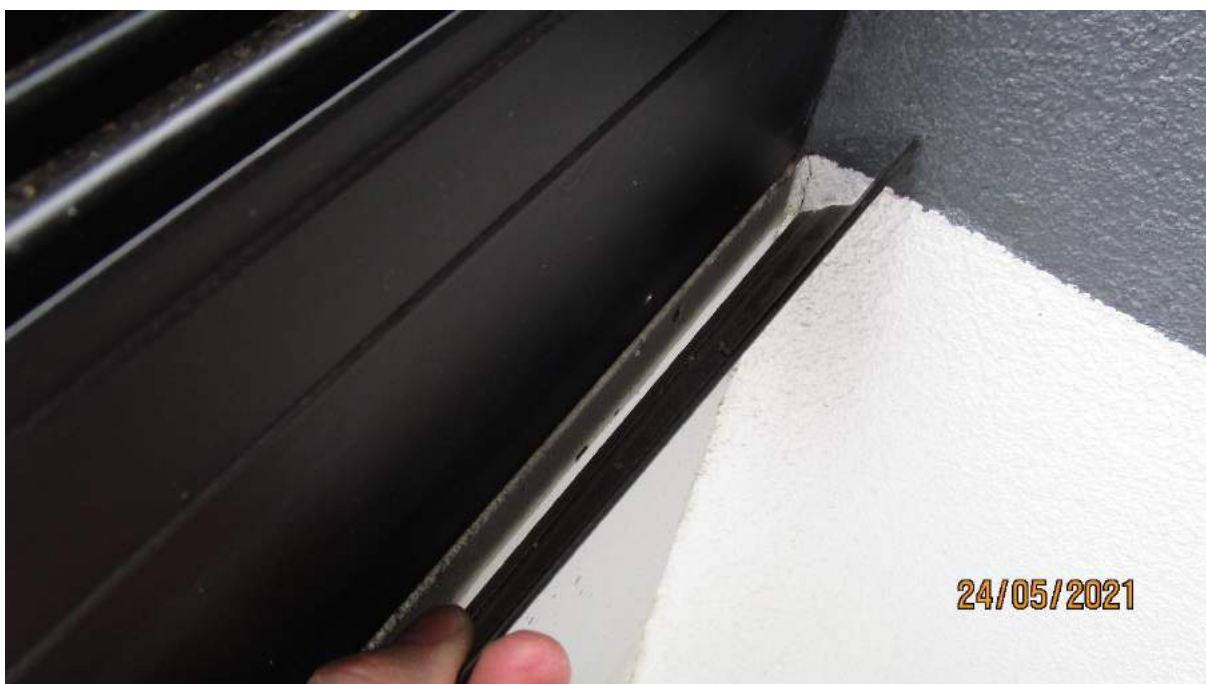
42) lišta nedrží na rámu
