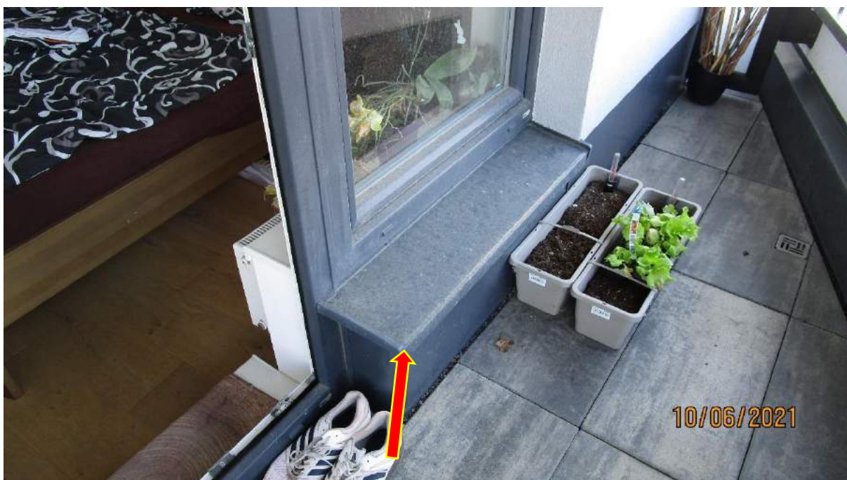
141) parapet nedrží na podkladu
