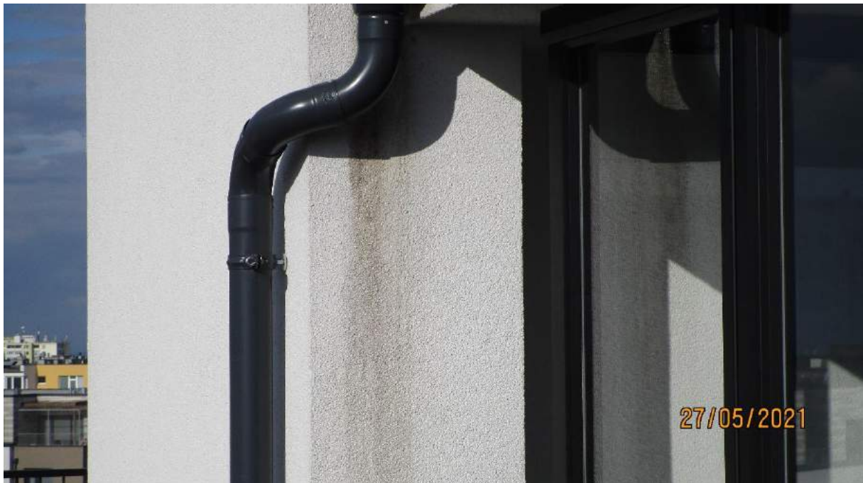
102) dešťová voda stéká mimo žlab po fasádě až na parapet okna .....
