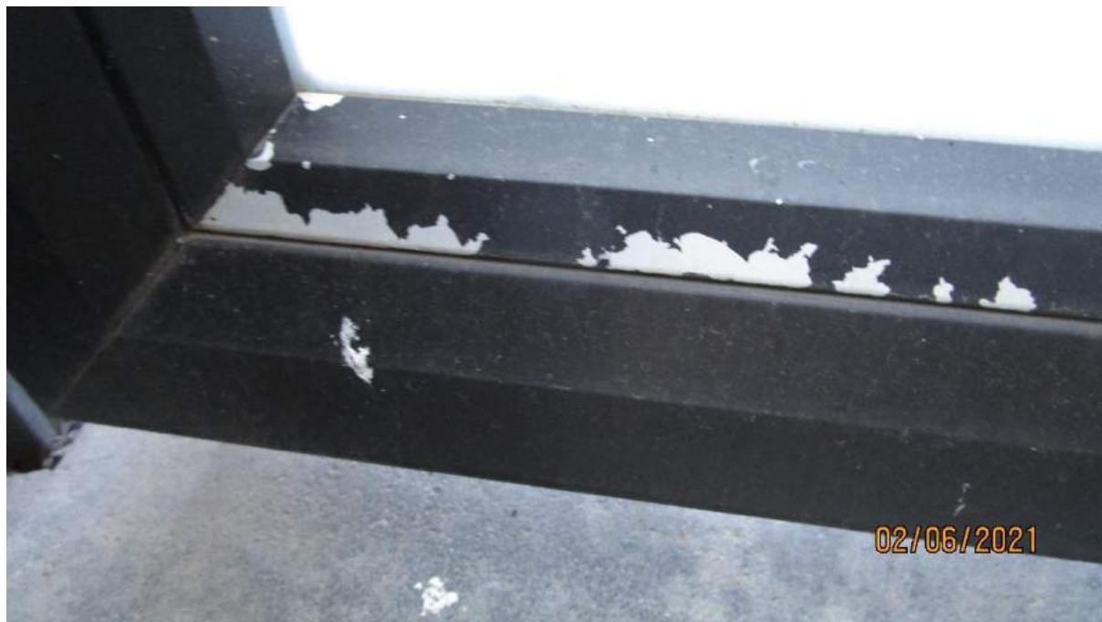
146) odlupuje se povrchová úprava rámu
