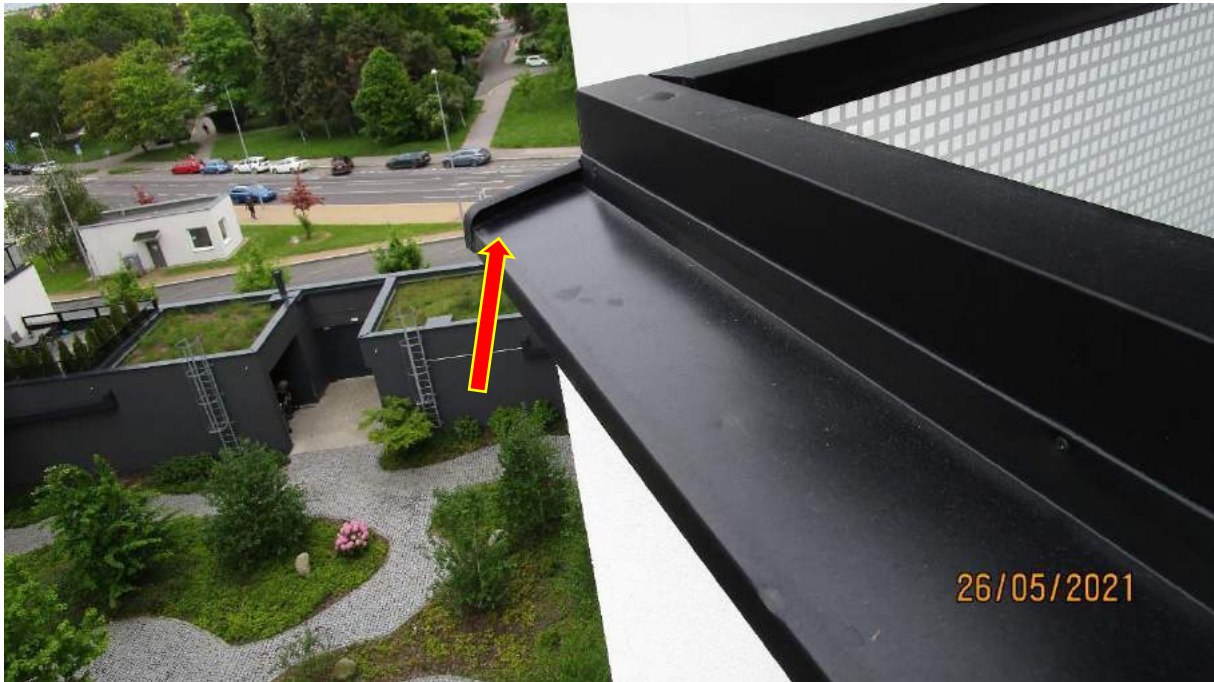
84) parapet nedrží na podkladu
