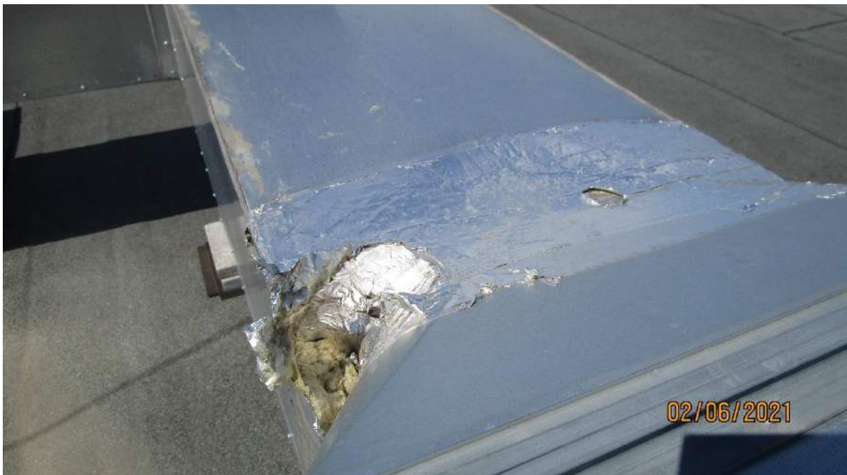
24) izolace VZT není soudržná
