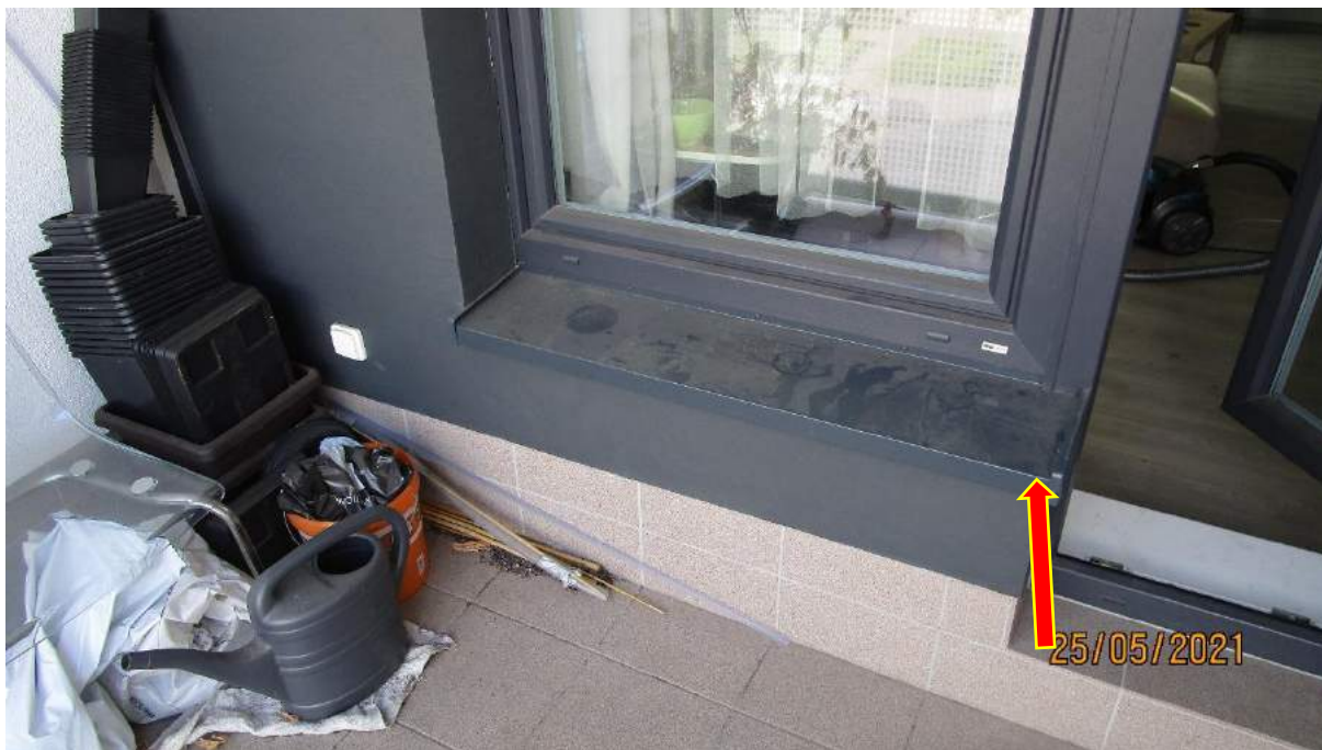
55) parapet nedrží na podkladu
