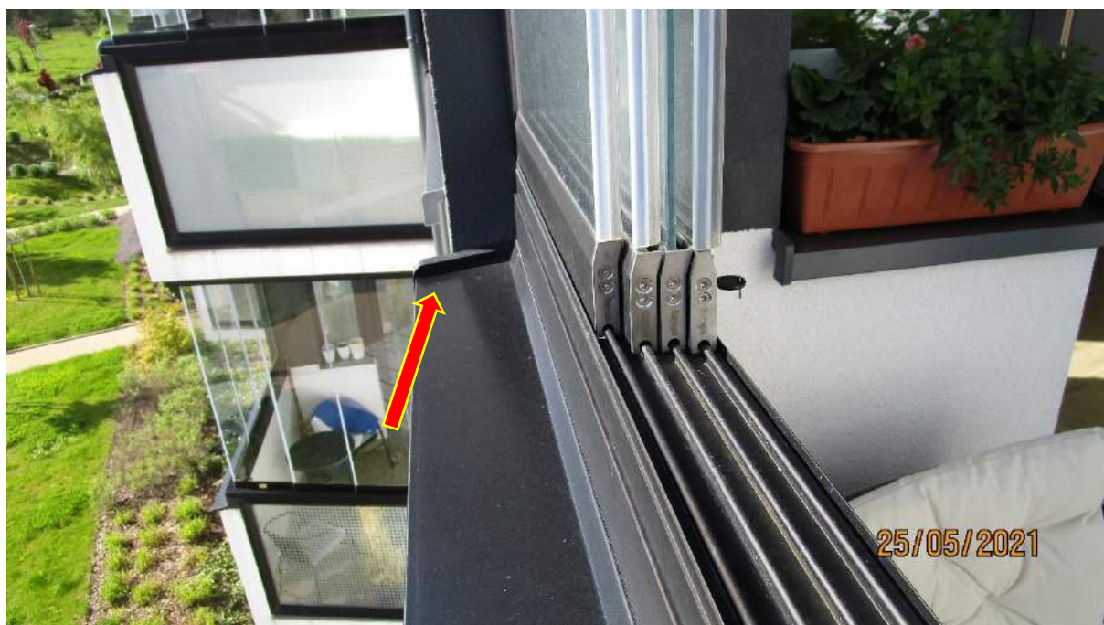
63) parapet nedrží na podkladu
