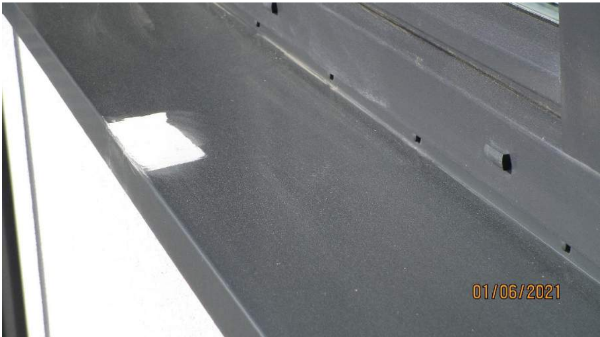
129) nedokončená oprava parapetu – již reklamováno
