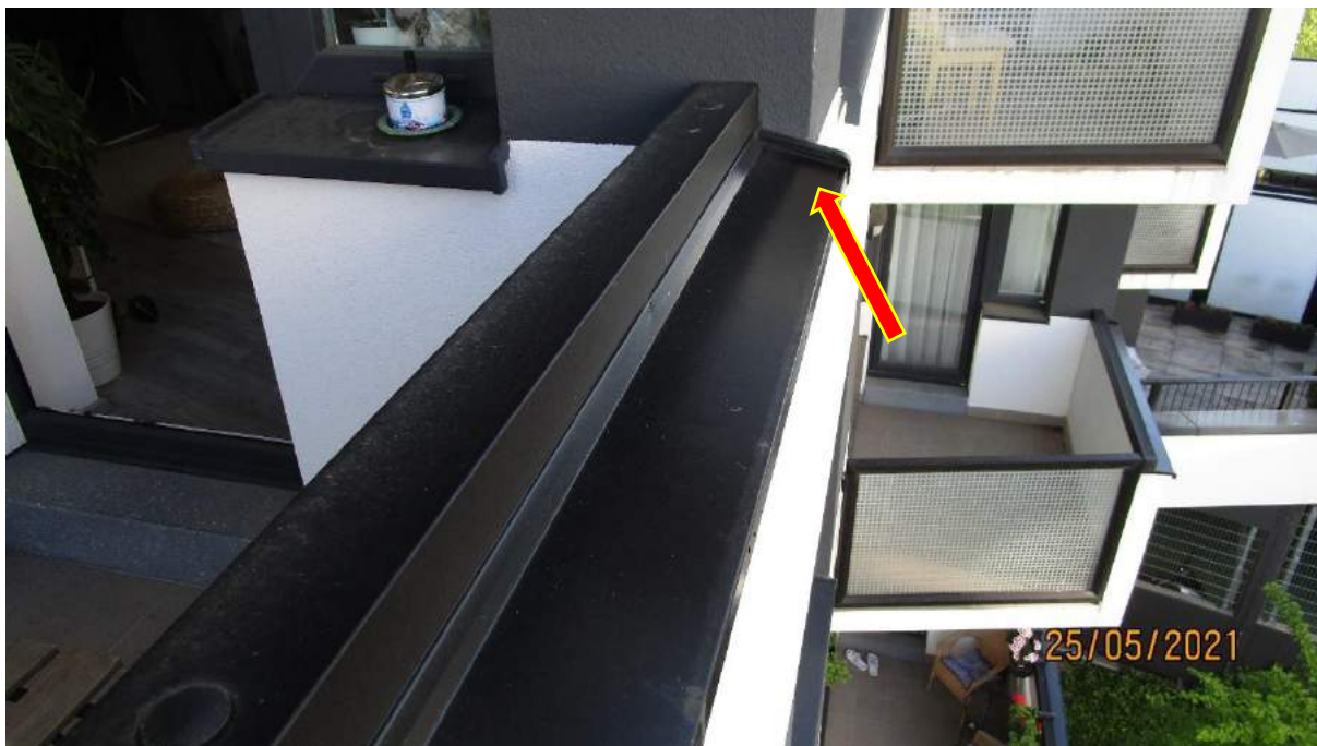
65) parapet nedrží na podkladu
