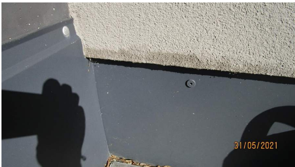
118) spodní okraj fasády se odchyluje od podkladu – lze s ním pohnout
