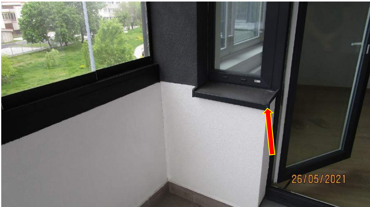
61) parapet nedrží na podkladu
