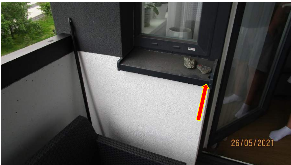
86) parapet nedrží na podkladu
