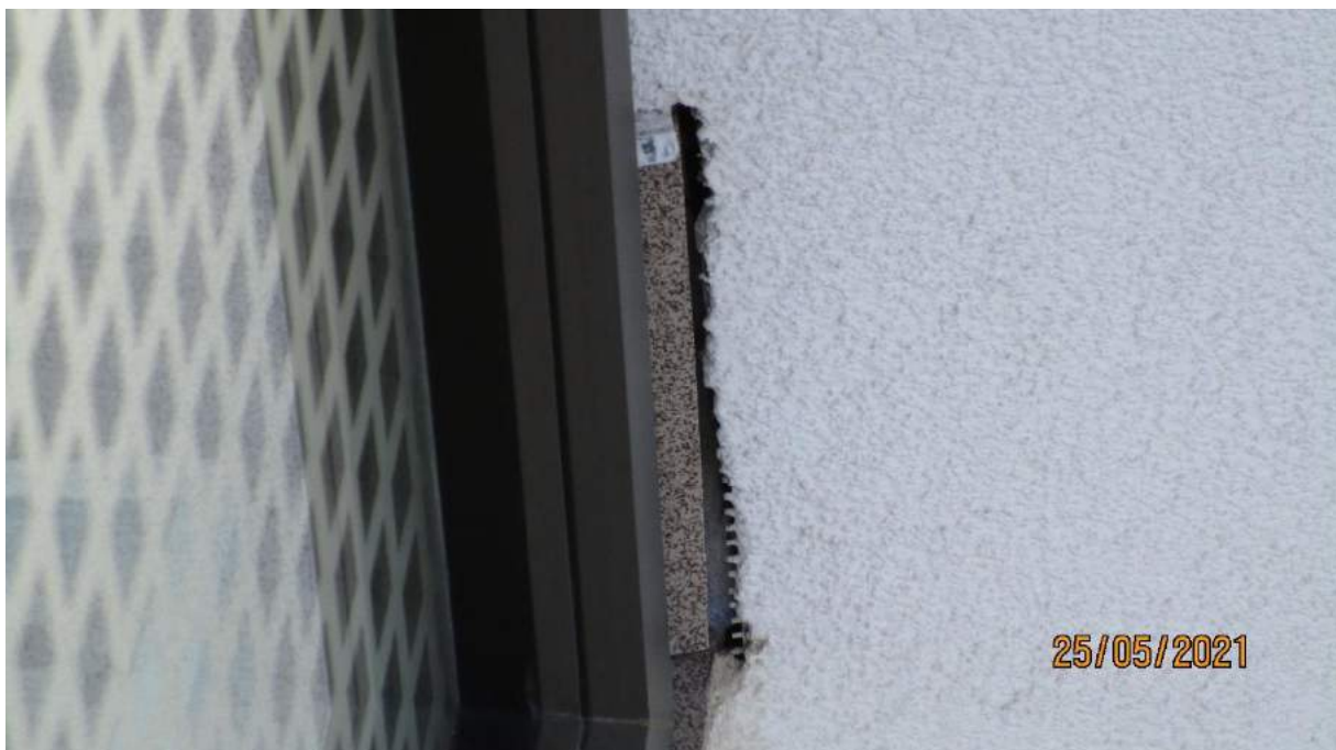
70) chybějící tmel ve spáře fasády a soklu
