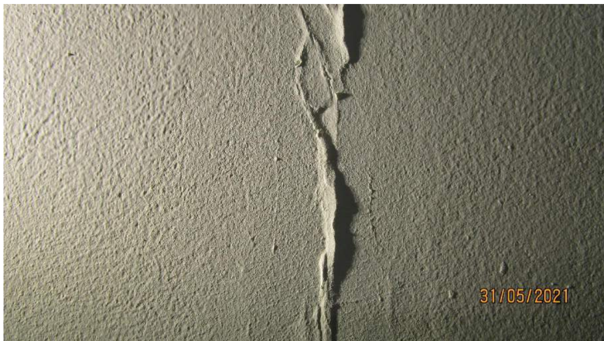
2) prasklina stěny – stání č. 118
