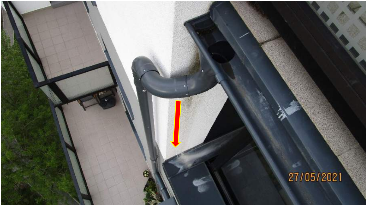
104) voda z terasy stéká po fasádě mimo žlab až na parapet okna v bytě č. 705
