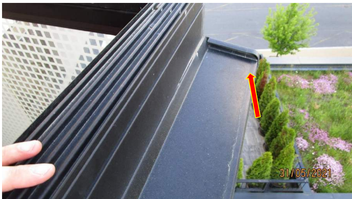
126) chybí nýt – parapet nedrží na podkladu
