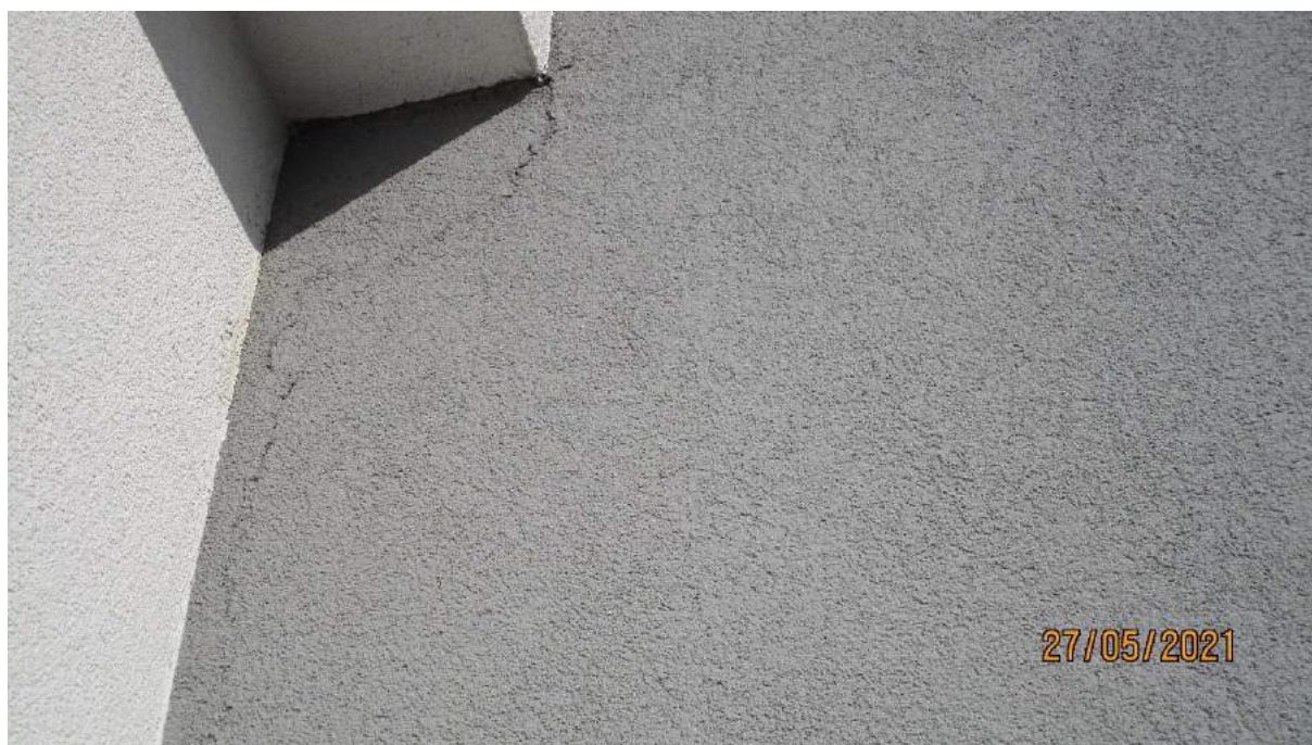
101) prasklina ve fasádě
