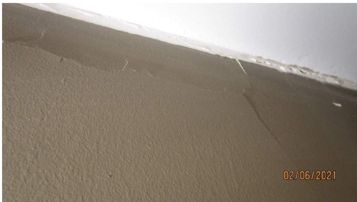
107) prasklina stěny – omítka nedrží na podkladu
