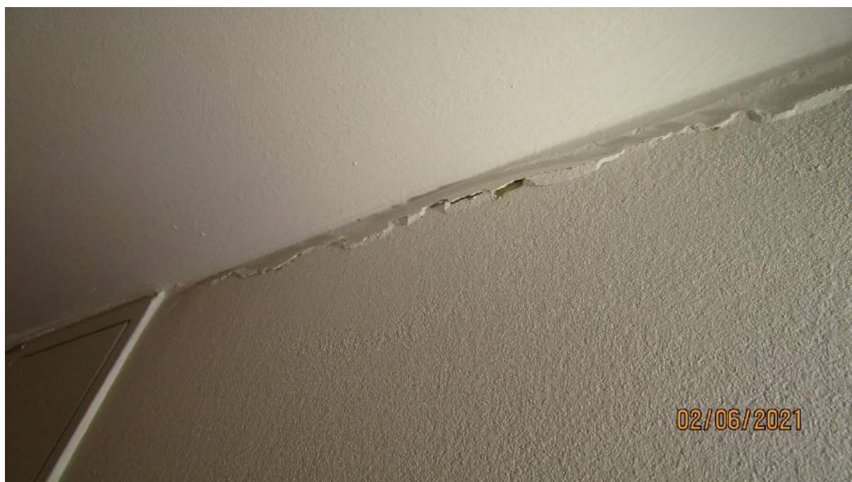
40) praskliny stěny (u bytu 613)
