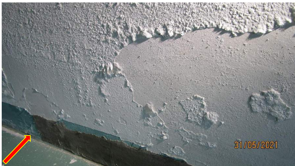
9) provlhá stěna – do stěny se dostává voda pravděpodobně spárou mezi podlahou a stěnou (v zimě voda z vozidel)
