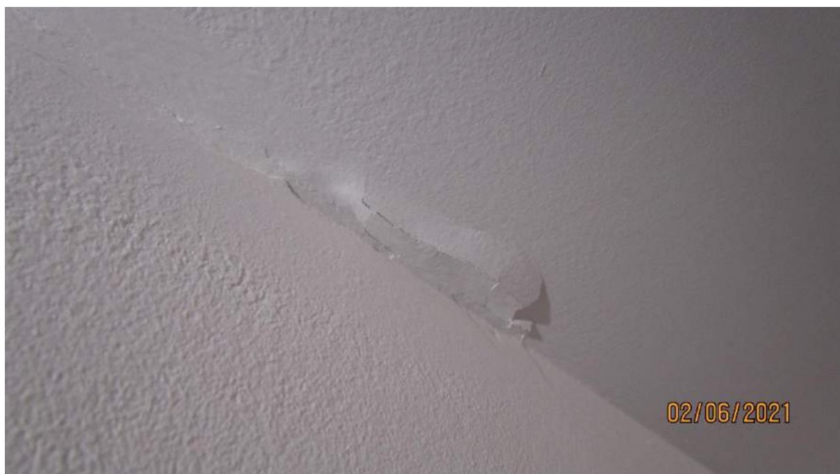
109) prasklina na stropě (u bytu 107)
