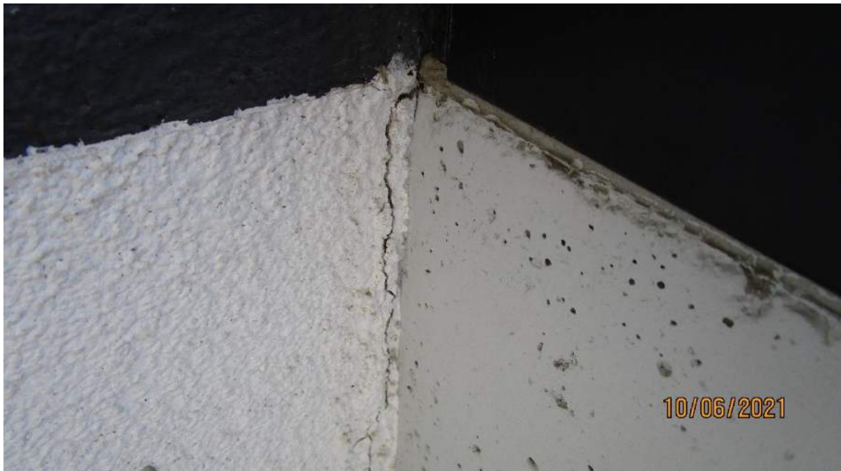
122) prasklina v rohu
