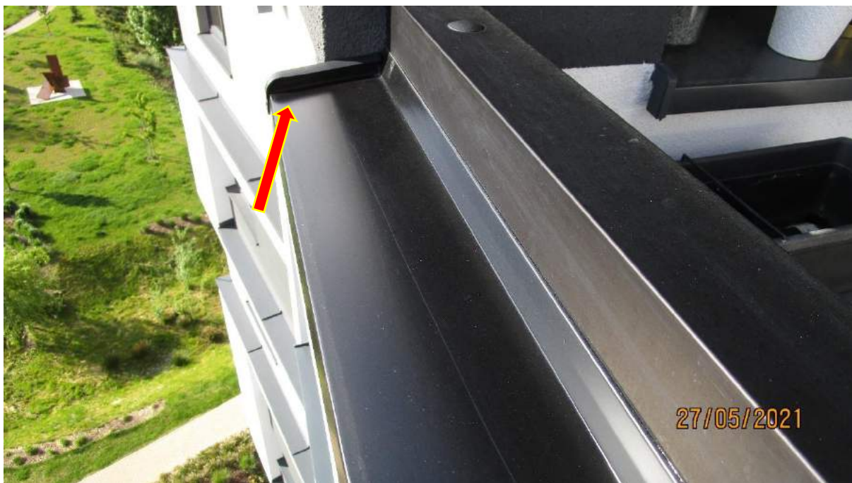
95) parapet nedrží na podkladu
