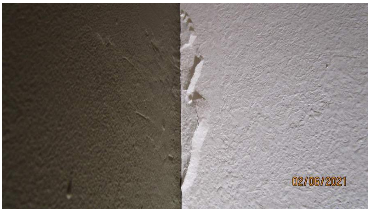
34) prasklina stěny v rohu (u bytu 411)
