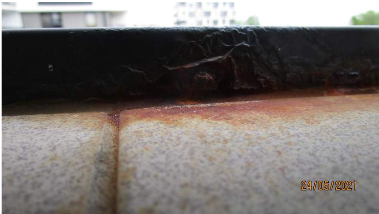
56) obvodová lišta podlahy balkonu koroduje
