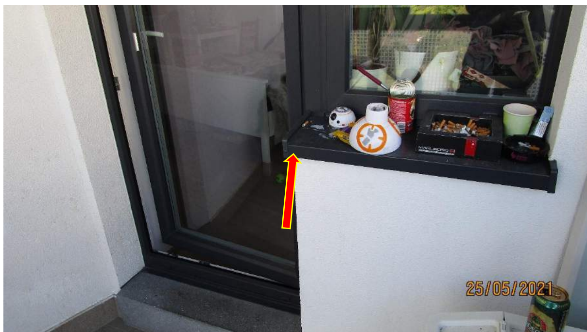
73) parapet nedrží na podkladu
