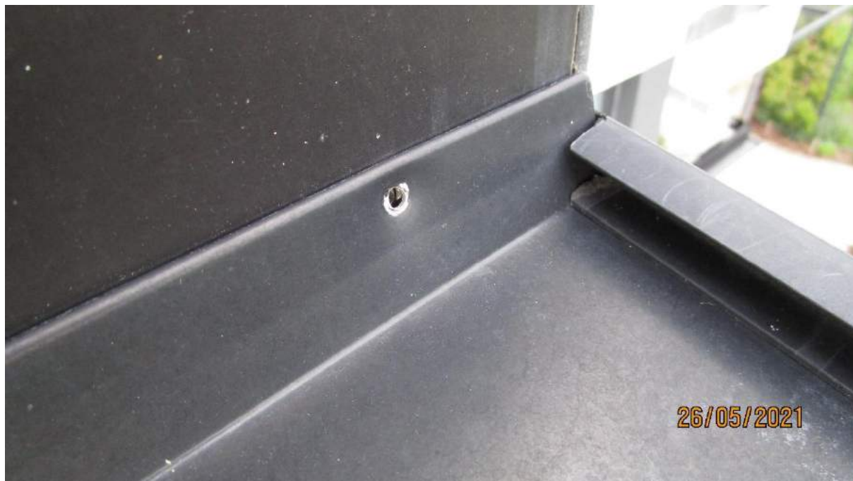
62) chybí nýt – parapet nedrží na podkladu
