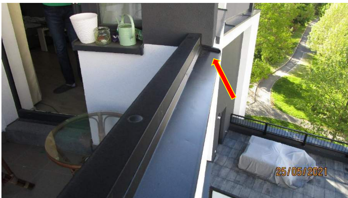
66) parapet nedrží na podkladu
