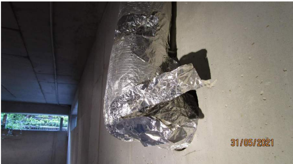
13) izolace potrubí není soudržná – stání 201
