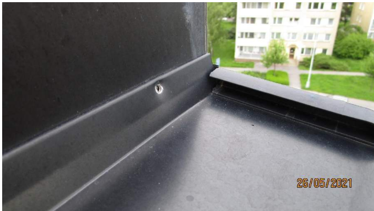
81) chybí nýt – parapet nedrží na podkladu
