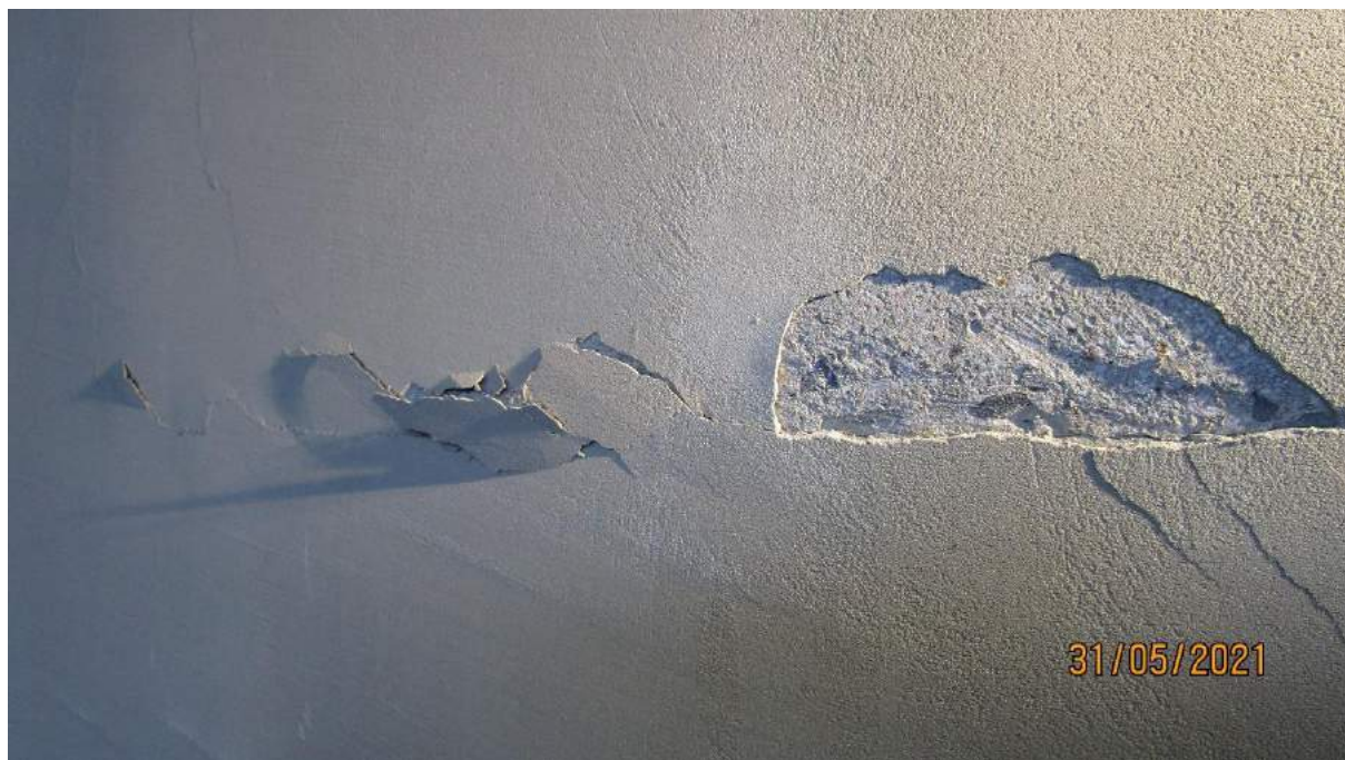
11) odlupující se omítka v prasklině
