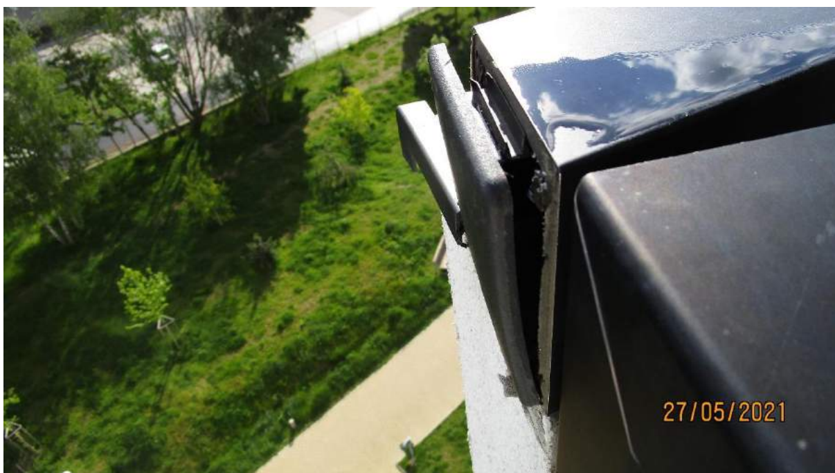
96) plastová krytka nedrží v kovovém profilu
