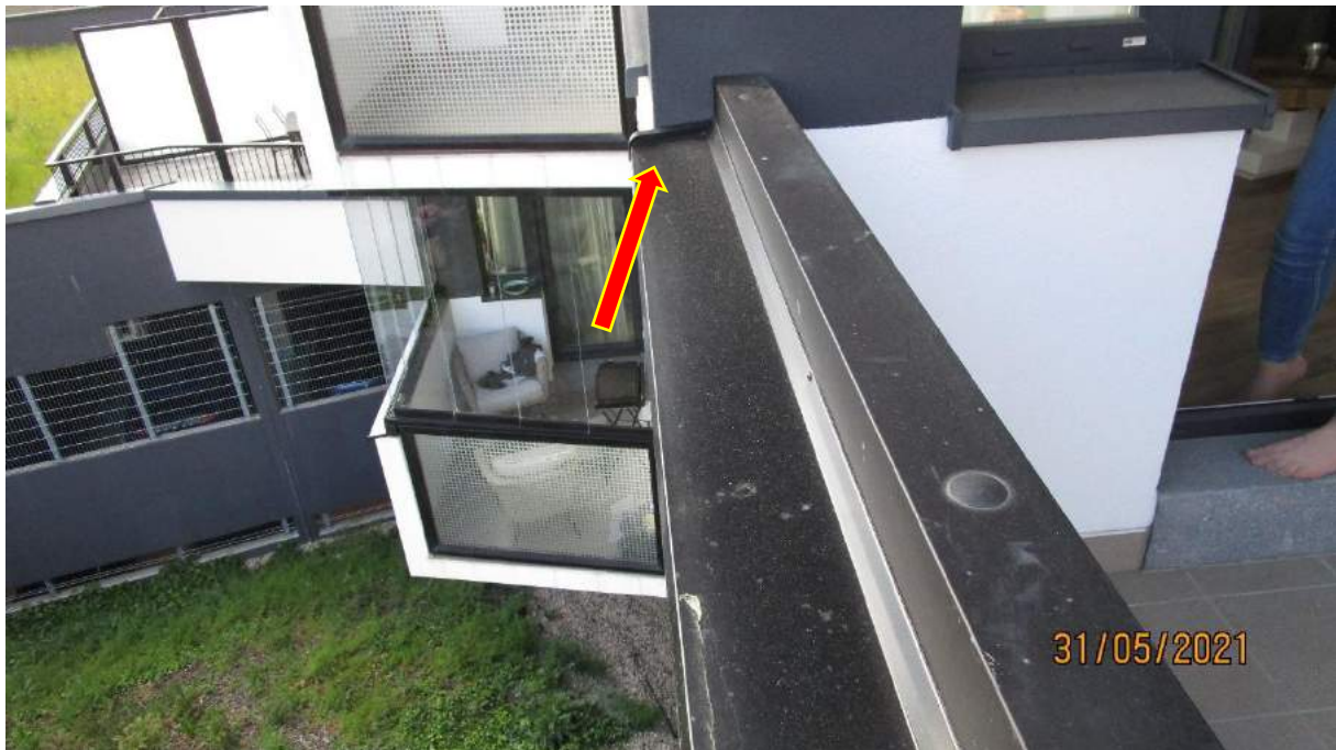
124) parapet nedrží na podkladu
