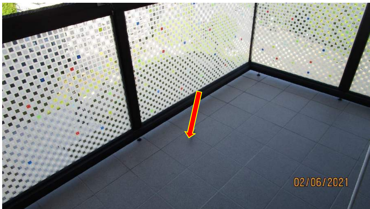
148) dlaždice nadrží na podkladu – při poklepu zní dutě
