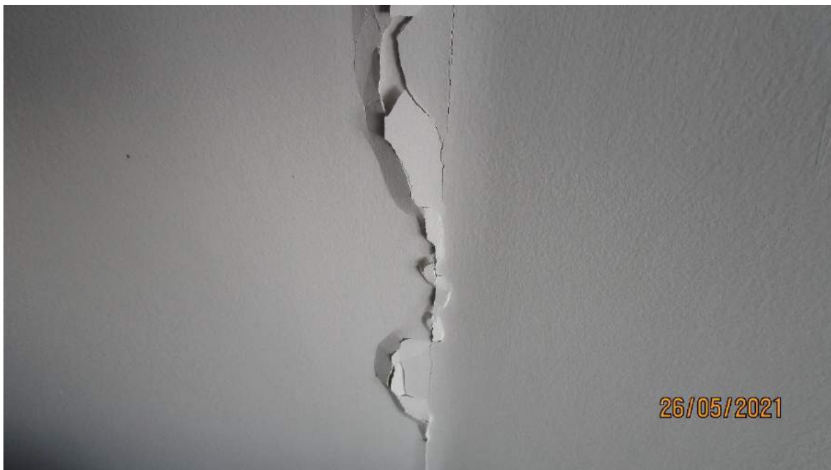
78) prasklina v obvodové stěně
