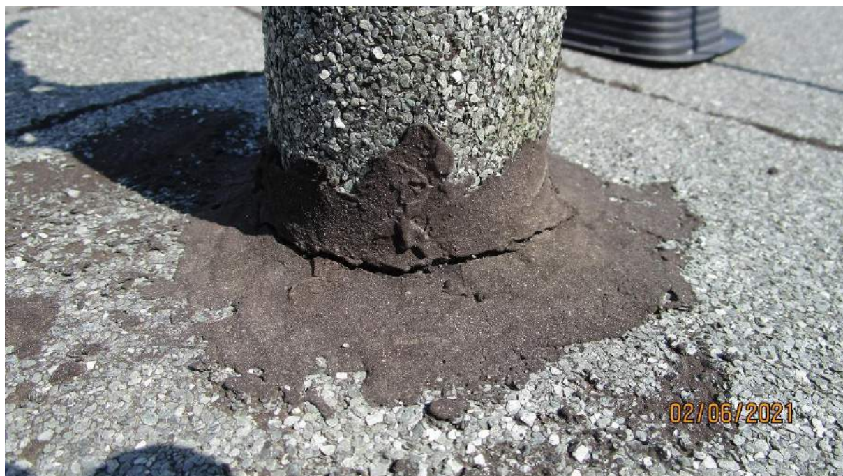
26) praskliny v hydroizolaci kotvícího systému
