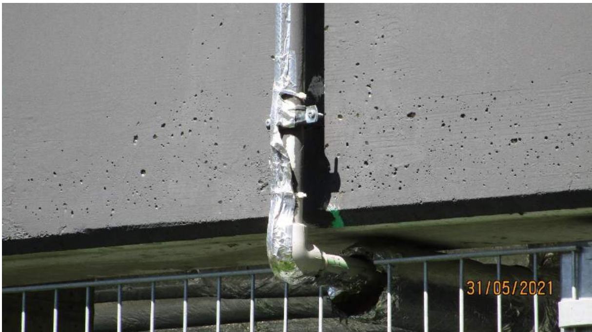
16) izolace potrubí není soudržná
