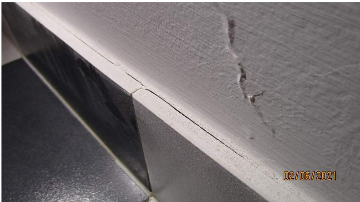
110) sokl nedrží na podkladu (u bytu 101)
