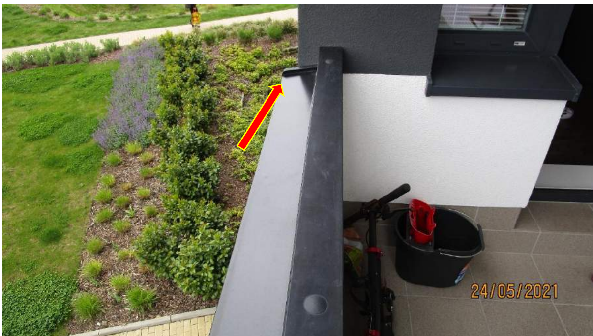
49) parapet nedrží na podkladu
