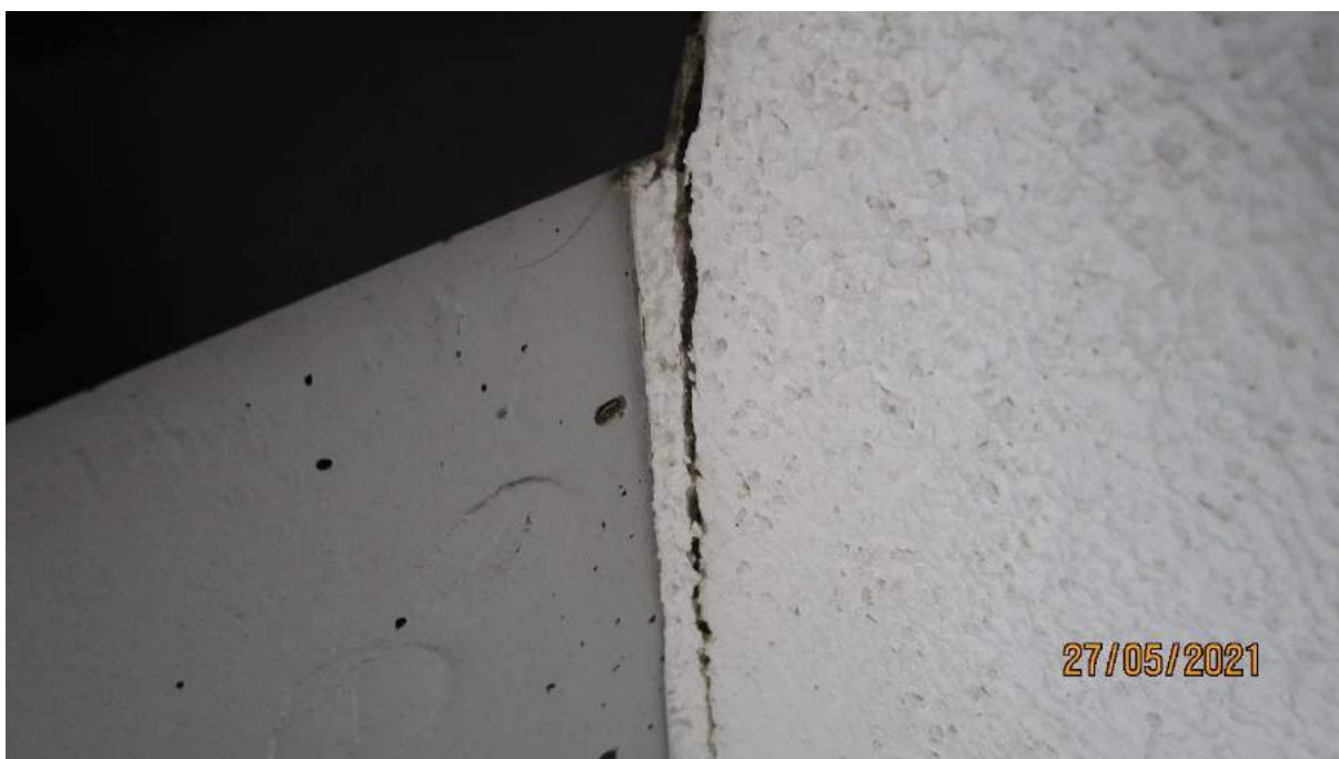
71) prasklina v rohu
