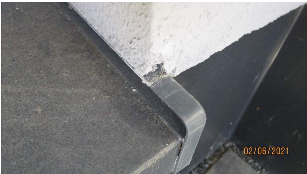
103) chybějící fasádní vrstva u koncovka parapetu
