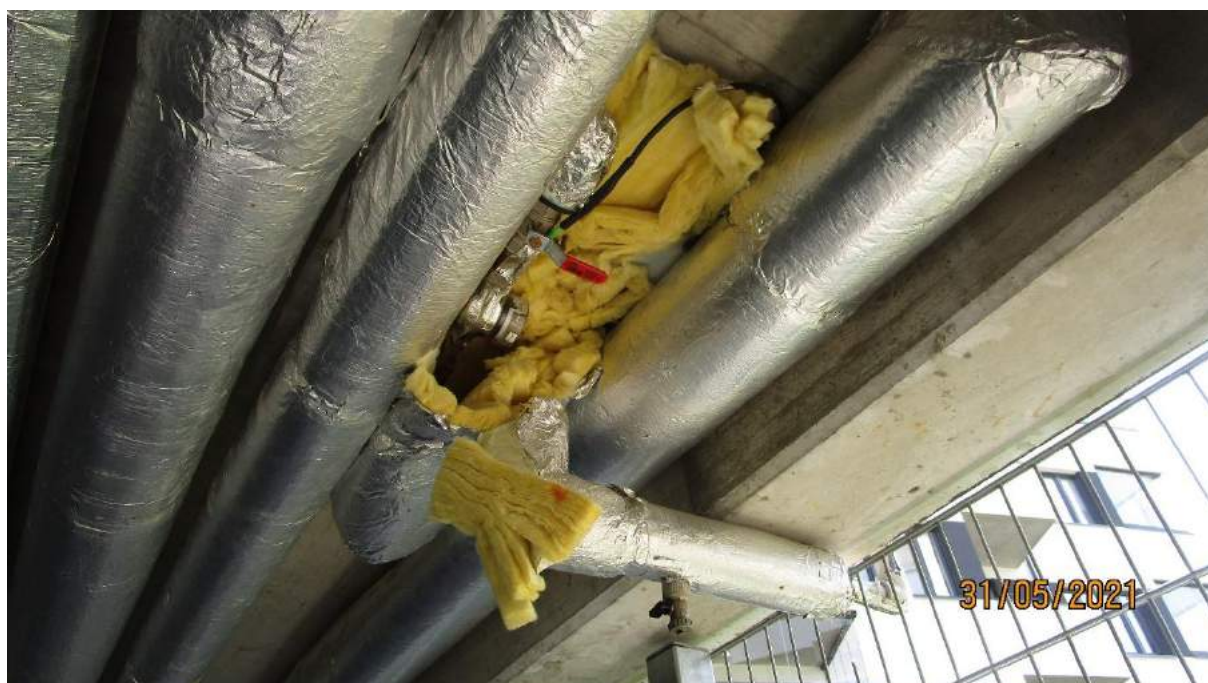
4) izolace potrubí není soudržná – stání č. 127
