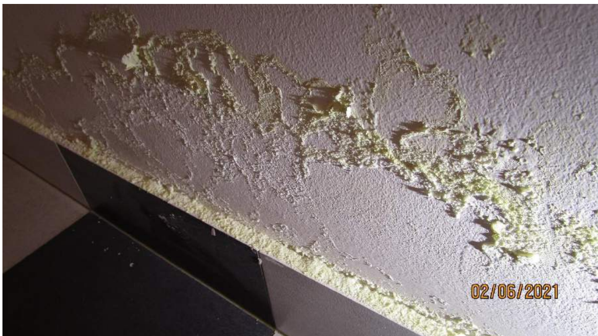
33) stěna se stopami provlhnutí (u bytu 306) – zdrojem je patrně koupelna bytu - nutno prověřit.
