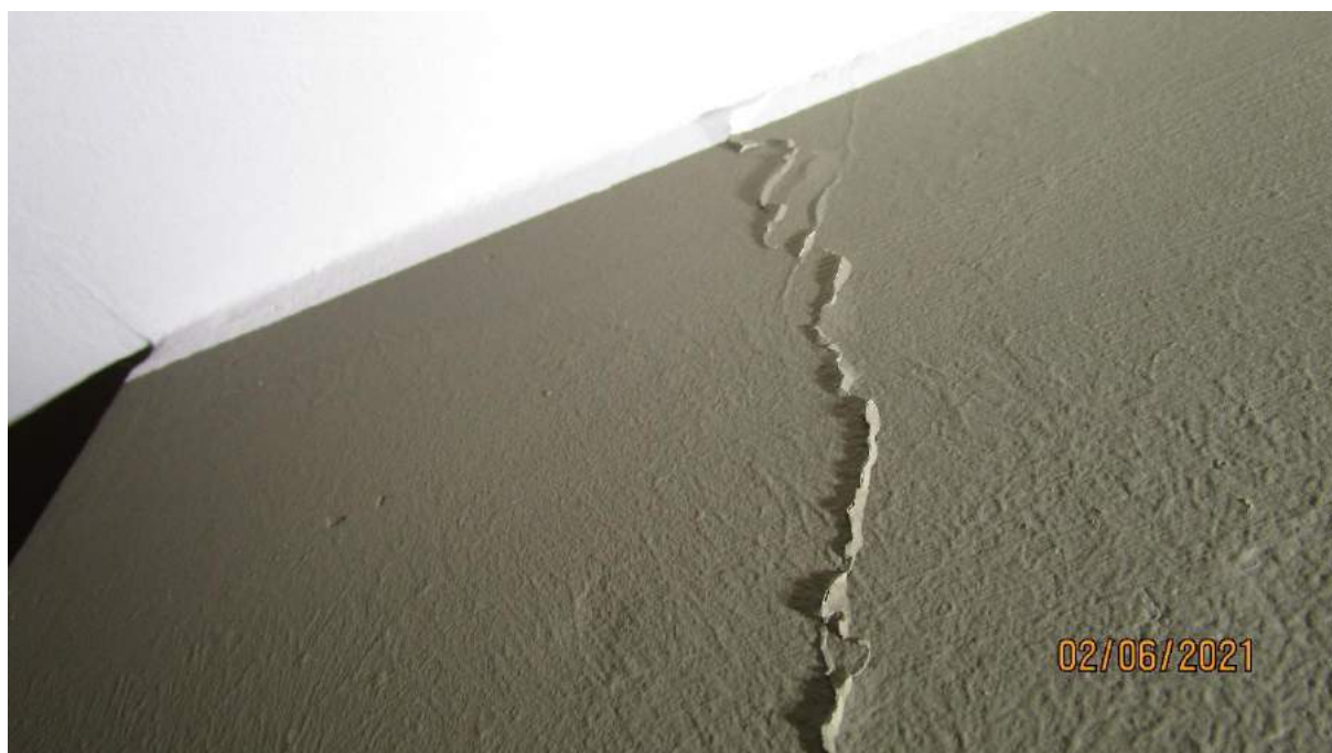
38) praskliny stěny (u bytu 612)
