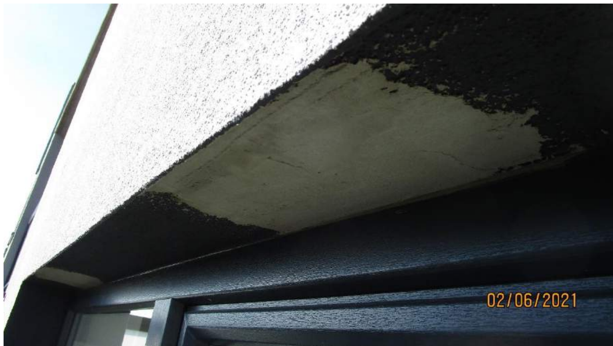
143) nedokončená záruční oprava nadpraží – již reklamováno
