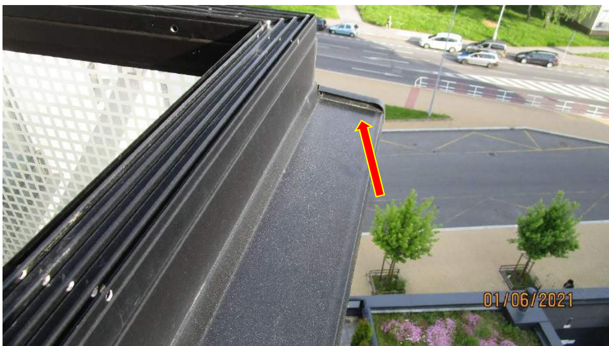
136) parapet nedrží na podkladu
