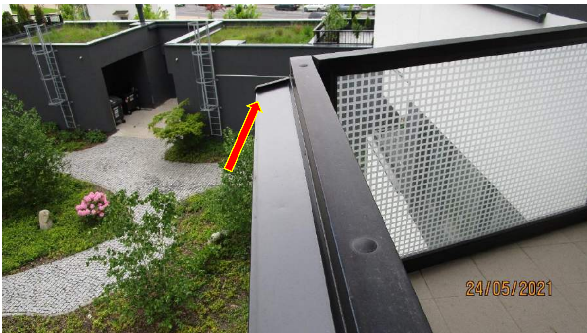
57) parapet nedrží na podkladu
