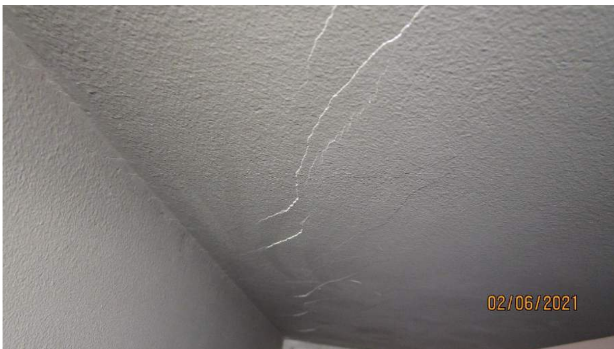
112) praskliny stěny (u bytu 404)
