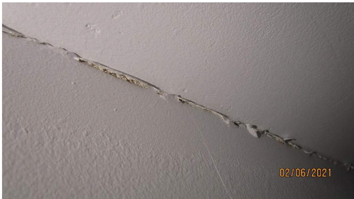
111) prasklina v rohu
