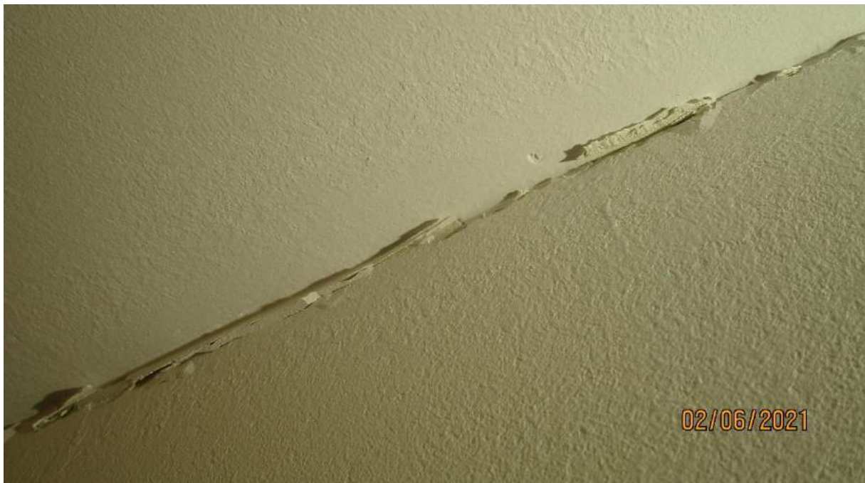
36) prasklina v rohu
