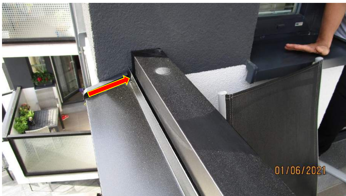
128) parapet nedrží na podkladu – chybí nýt
