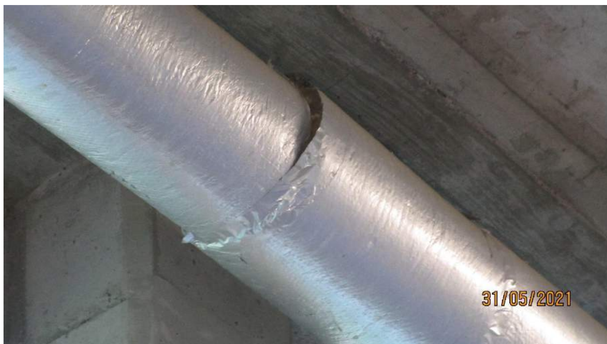
10) izolace potrubí není soudržná
