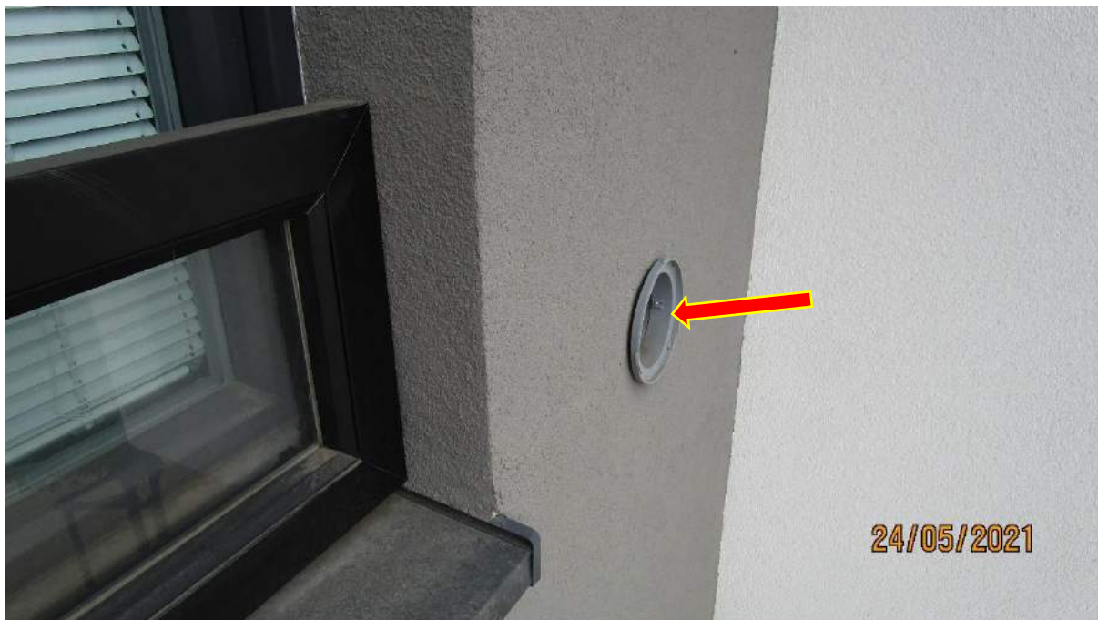
45) kryt provětrávacího otvoru nedrží na svém místě – kryt se samovolně oddělil
