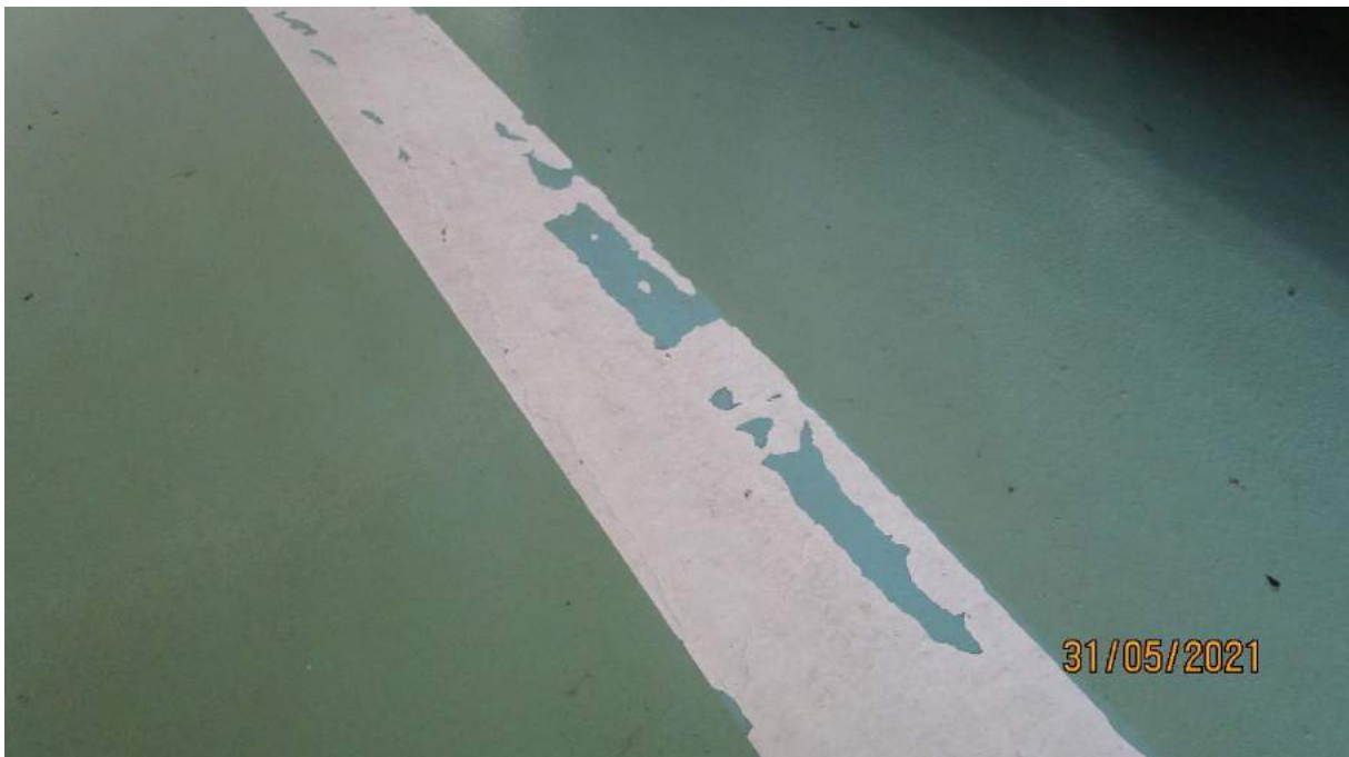
8) vodorovné dopravní značení se odlupuje
