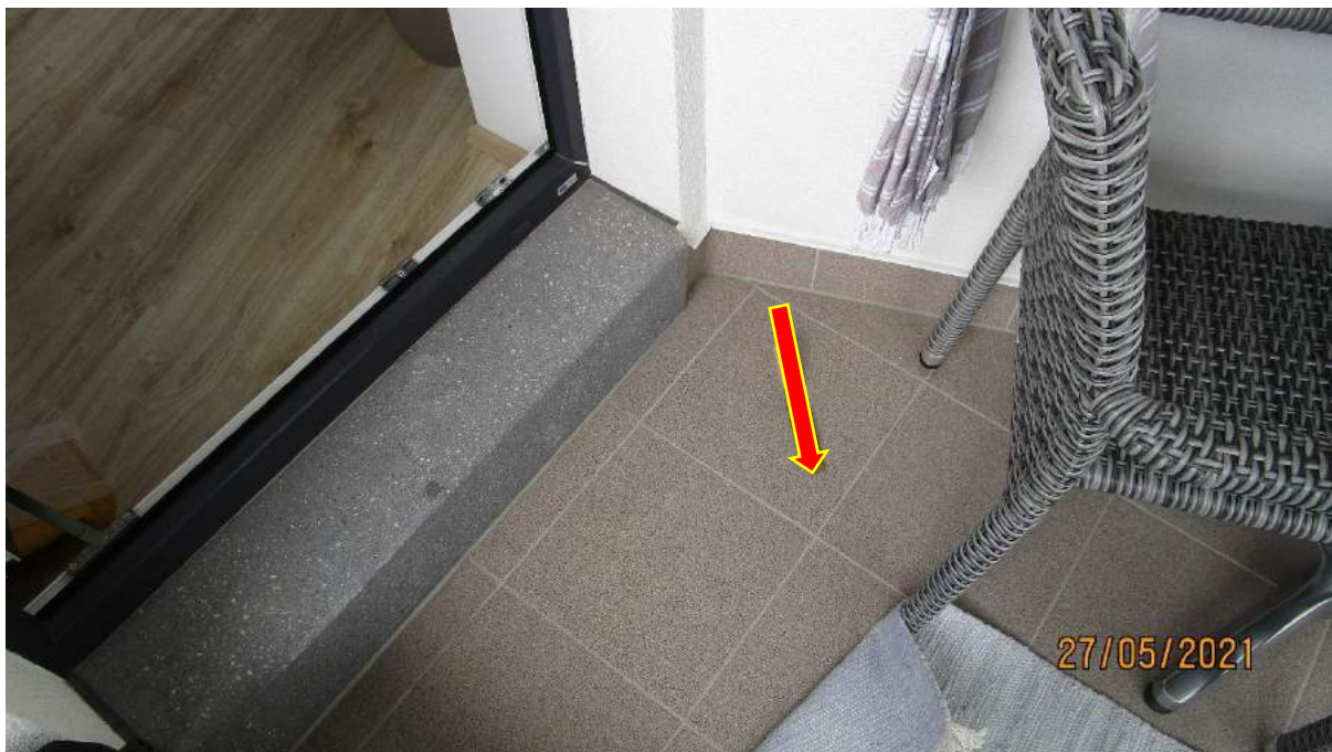
87) dlažba nadrží na podkladu – při poklepu zní dutě
