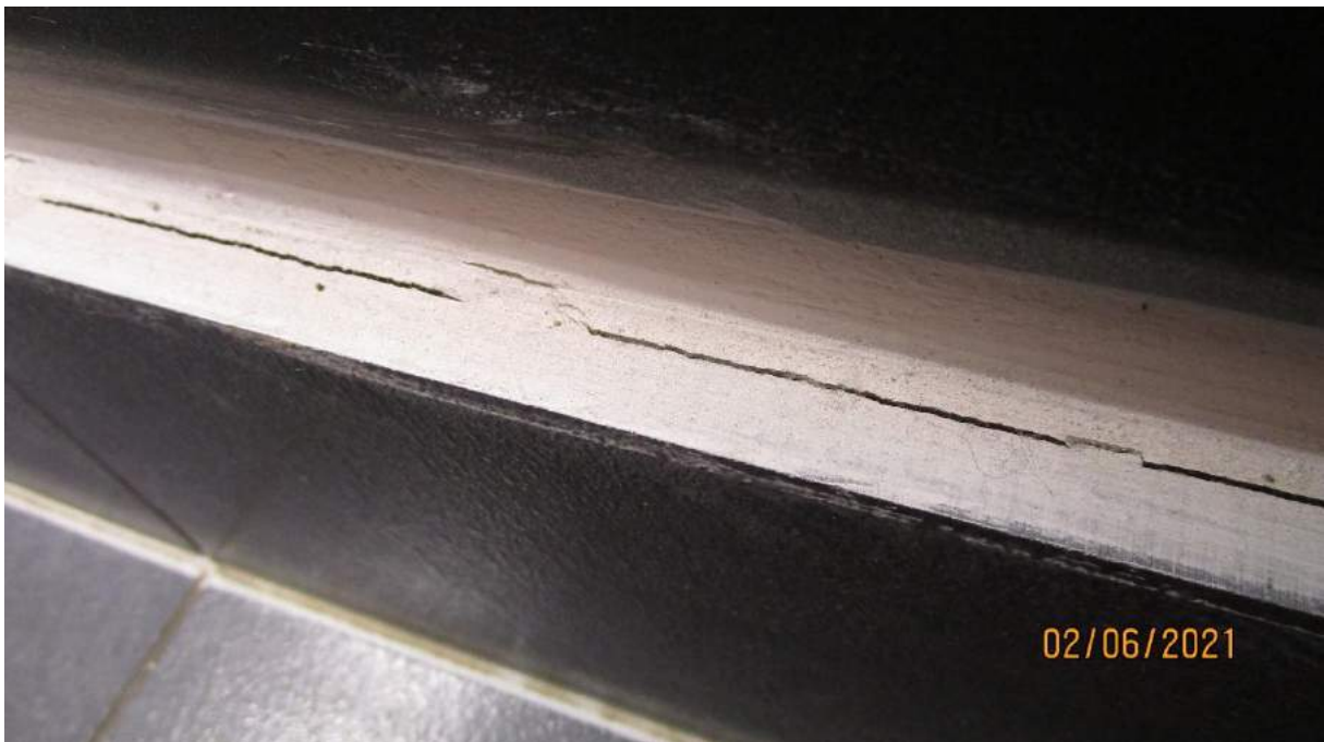
106) sokl nedrží na podkladu
