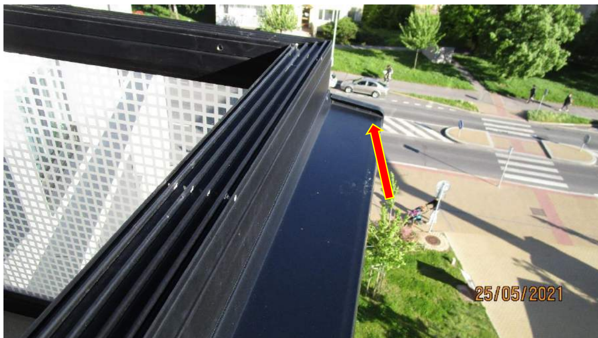
72) parapet nedrží na podkladu
