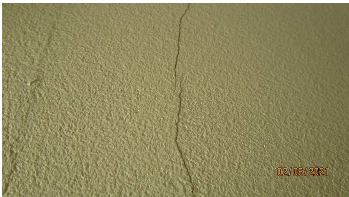
32) prasklina stěny (u bytu 208)
