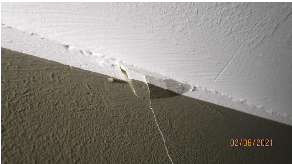
39) praskliny stěny (u místnosti K602)
