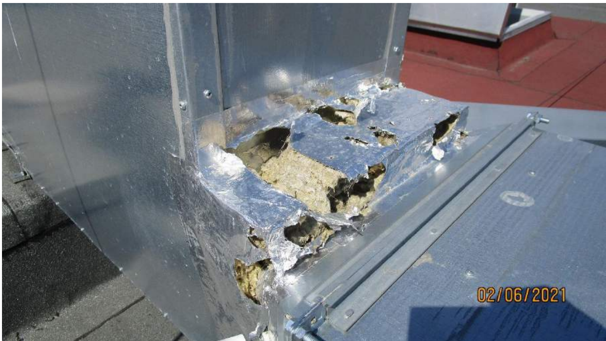
22) izolace VZT není soudržná
