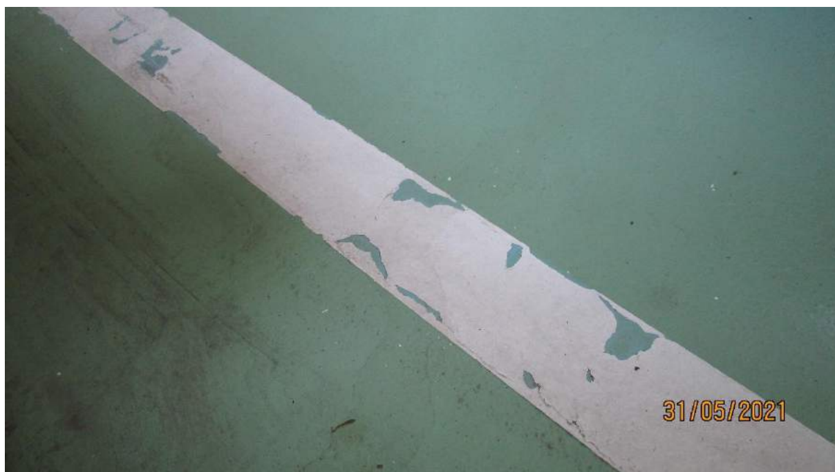
5) vodorovné dopravní značení se odlupuje – stání č. 130
