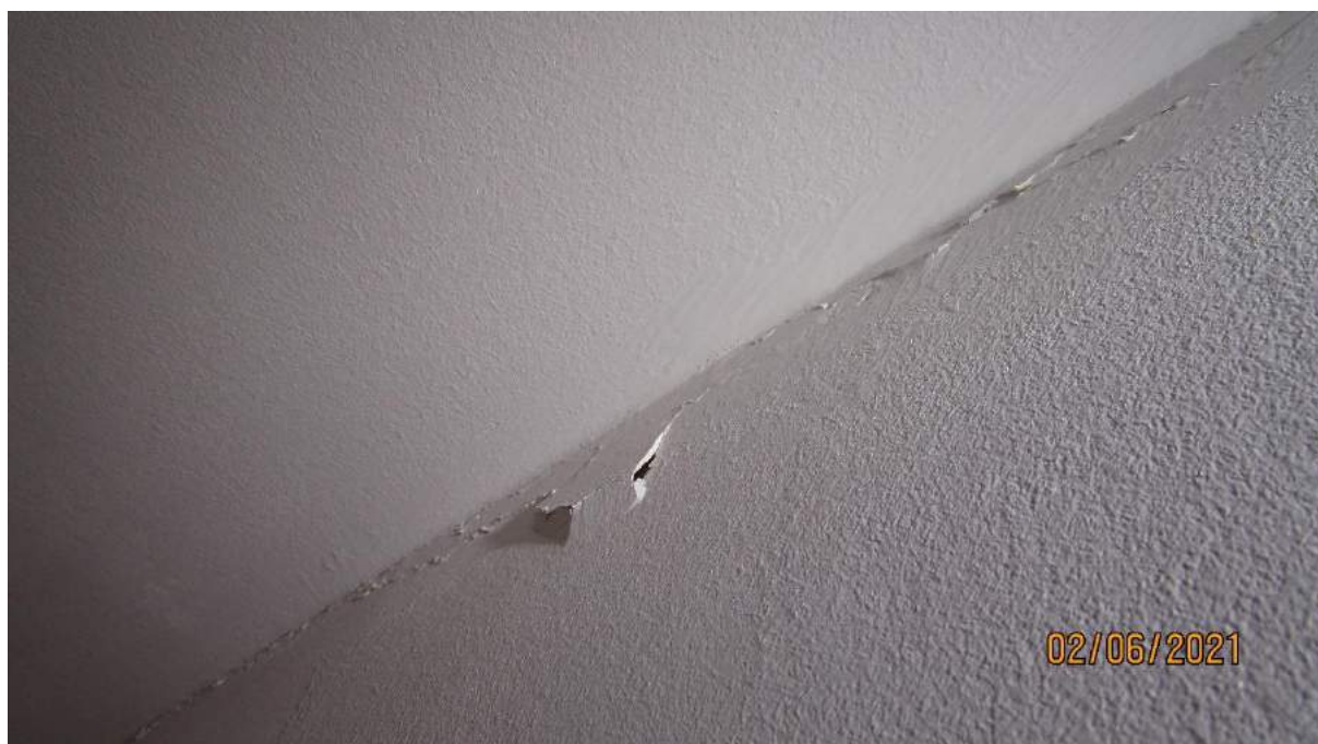
37) praskliny stěny (u bytu 608)
