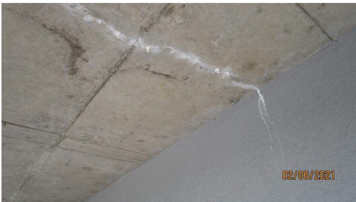
151) prasklinami ve stropě zatéká
