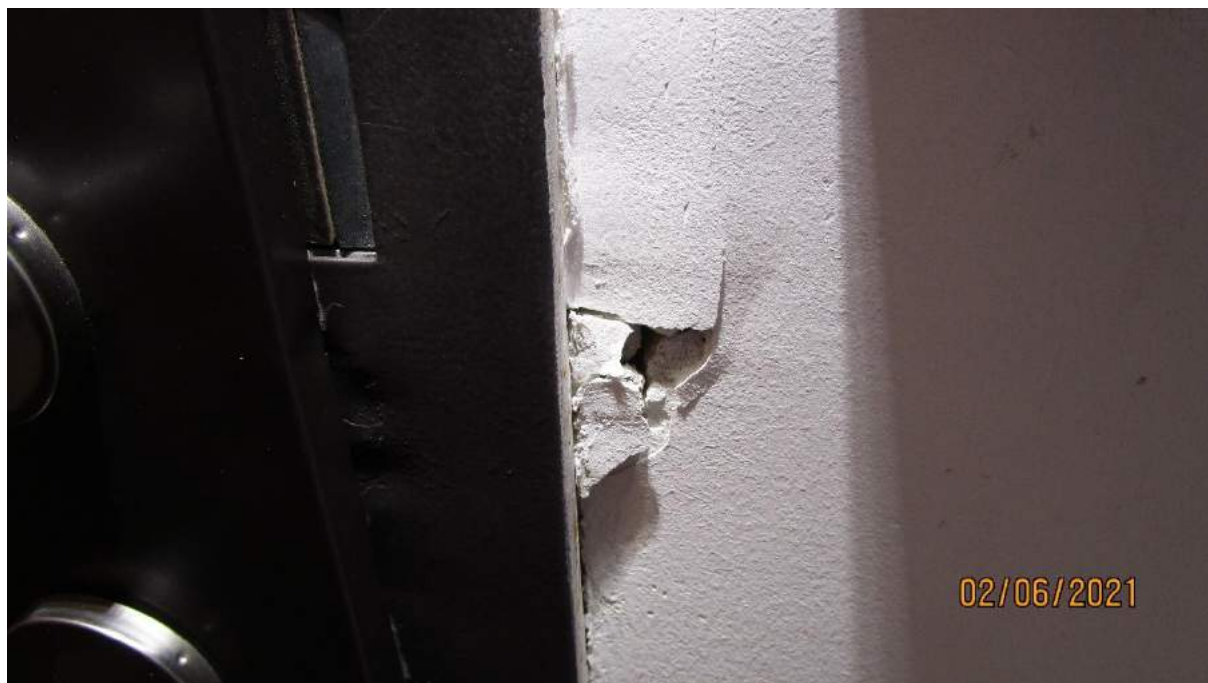
28) vydrolená stěna u zárubně
