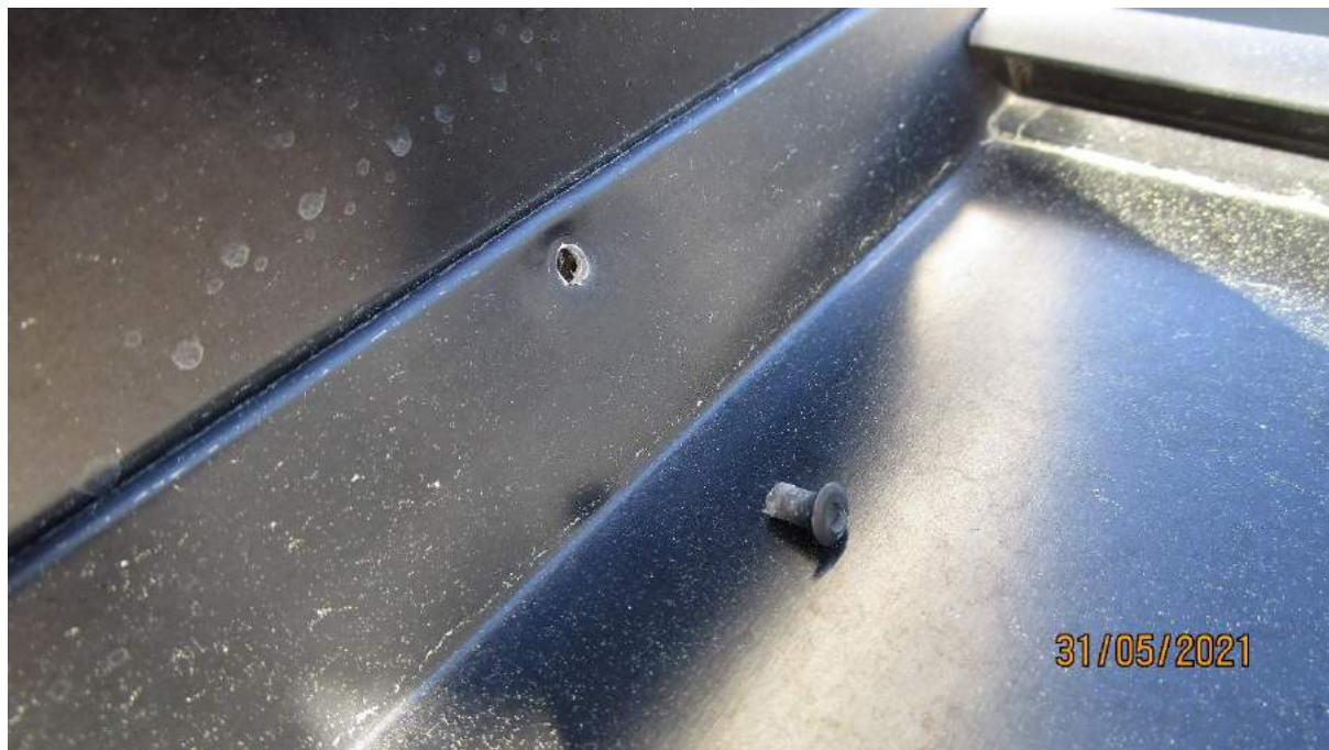
125) chybí nýt – parapet nedrží na podkladu
