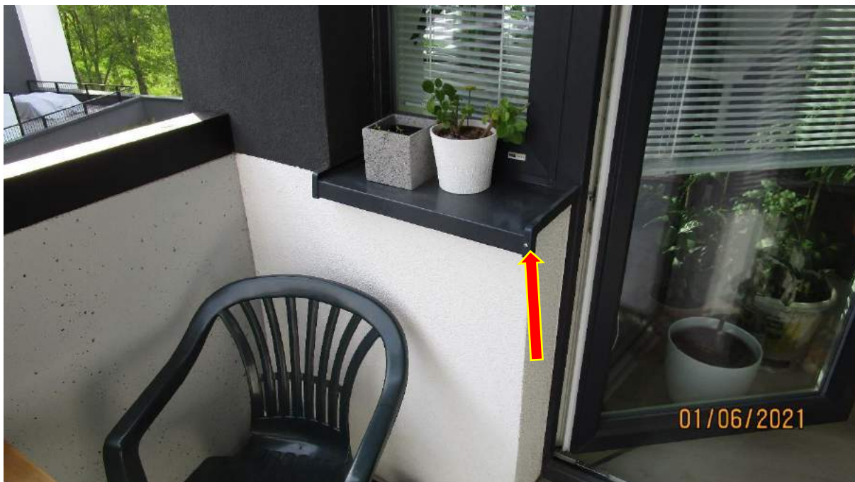
130) parapet nedrží na podkladu
