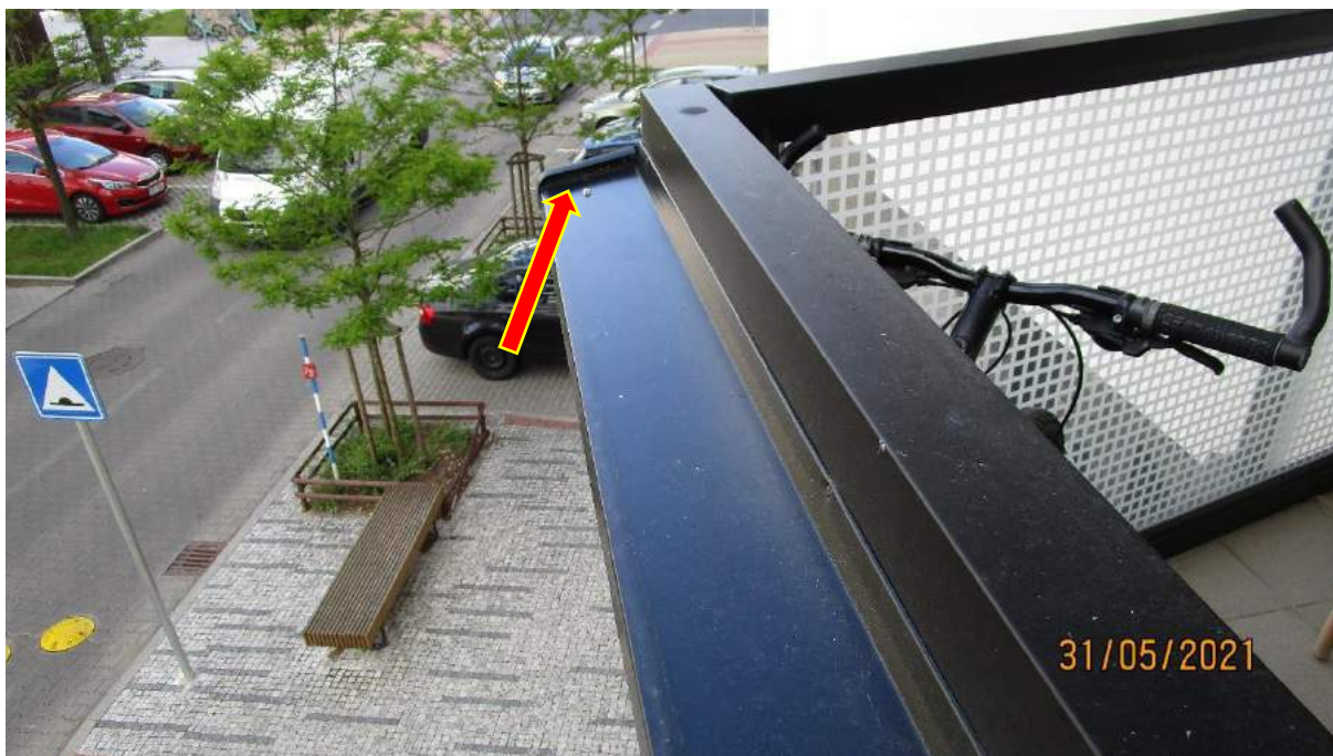
120) parapet nedrží na podkladu
