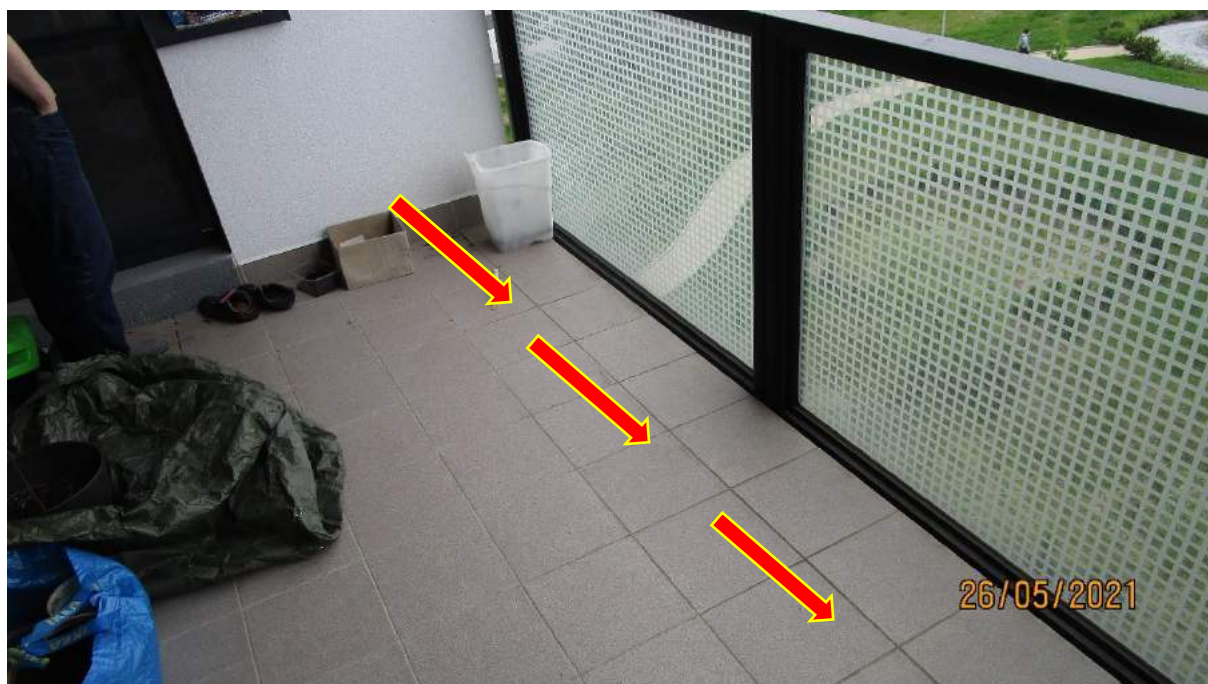
76) dlaždice nedrží na podkladu – při poklepu vydávají dutý zvuk
