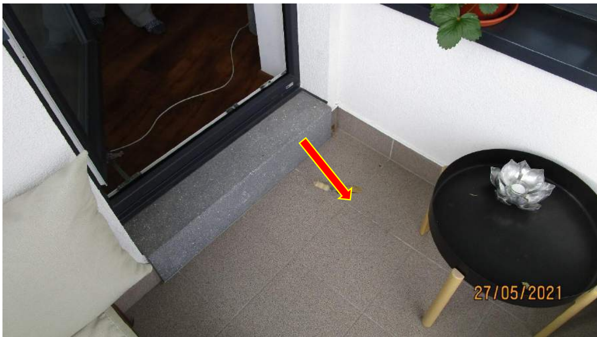
99) dlažba nadrží na podkladu – při poklepu zní dutě
