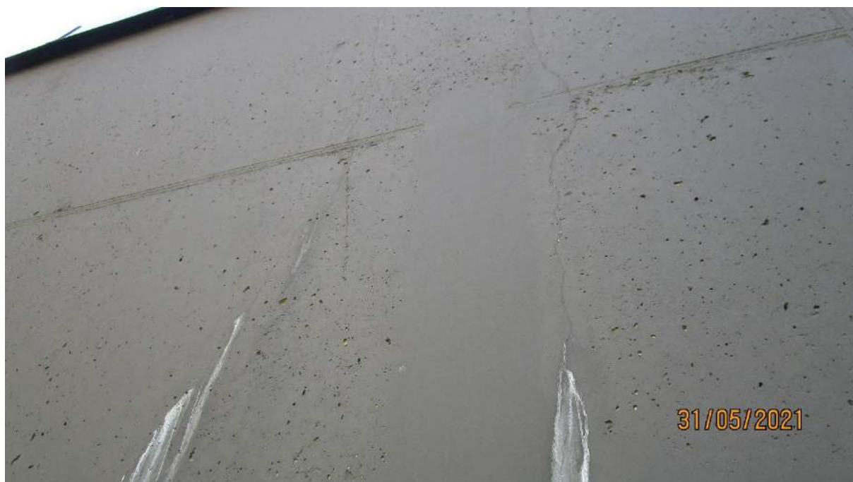
17) z prasklin prostupuje voda a zanechává na povrchu stopy
