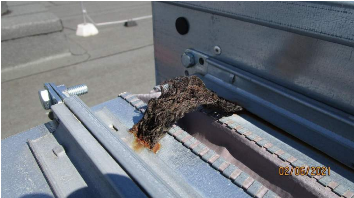
23) spojení mezi prvky VZT koroduje
