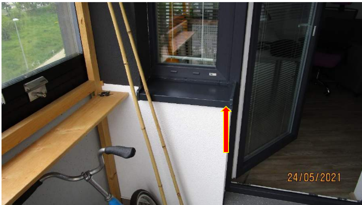
53) parapet nedrží na podkladu
