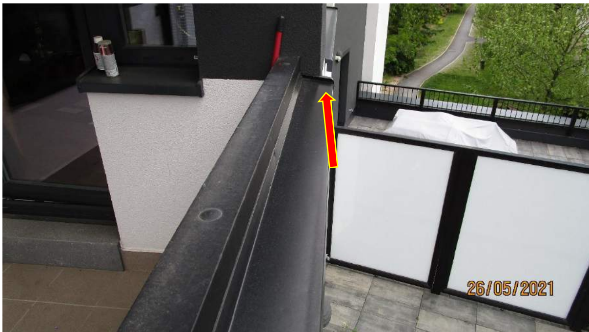
59) parapet nedrží na podkladu
