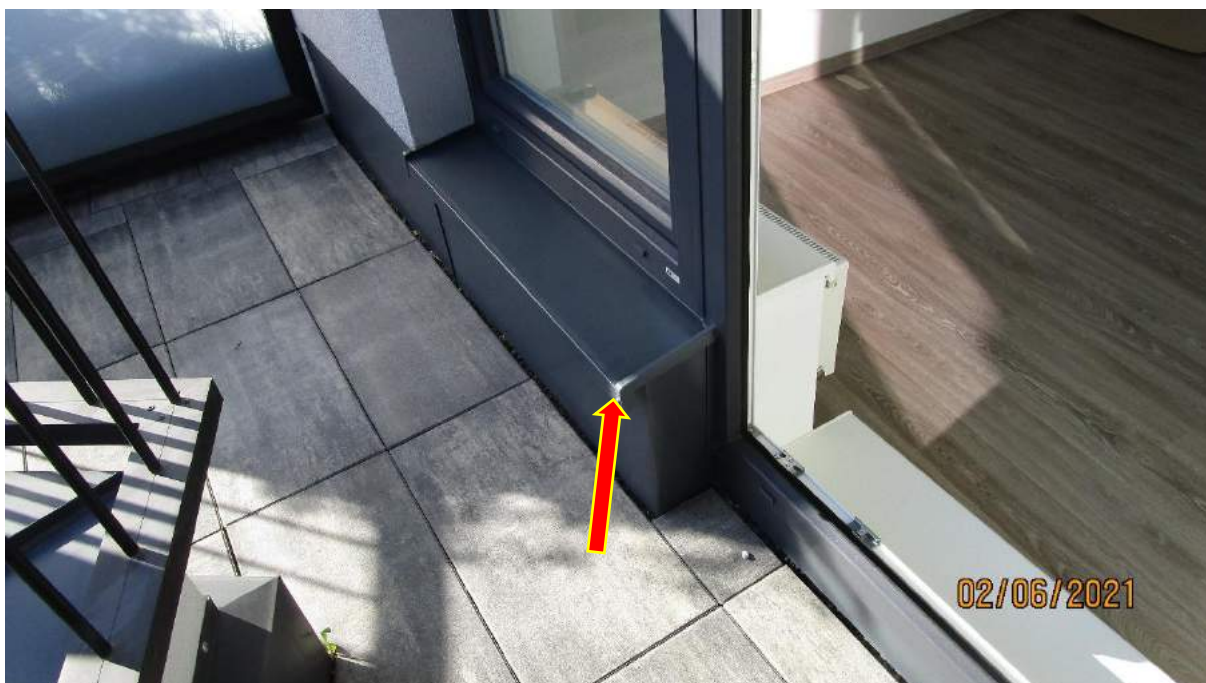
142) parapet nedrží na podkladu
