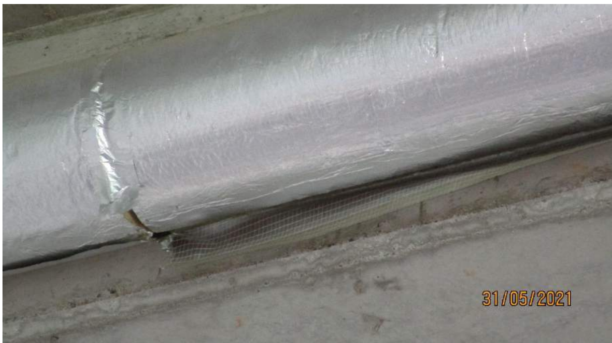
12) izolace potrubí není soudržná
