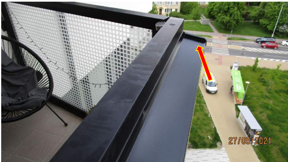
97) parapet nedrží na podkladu
