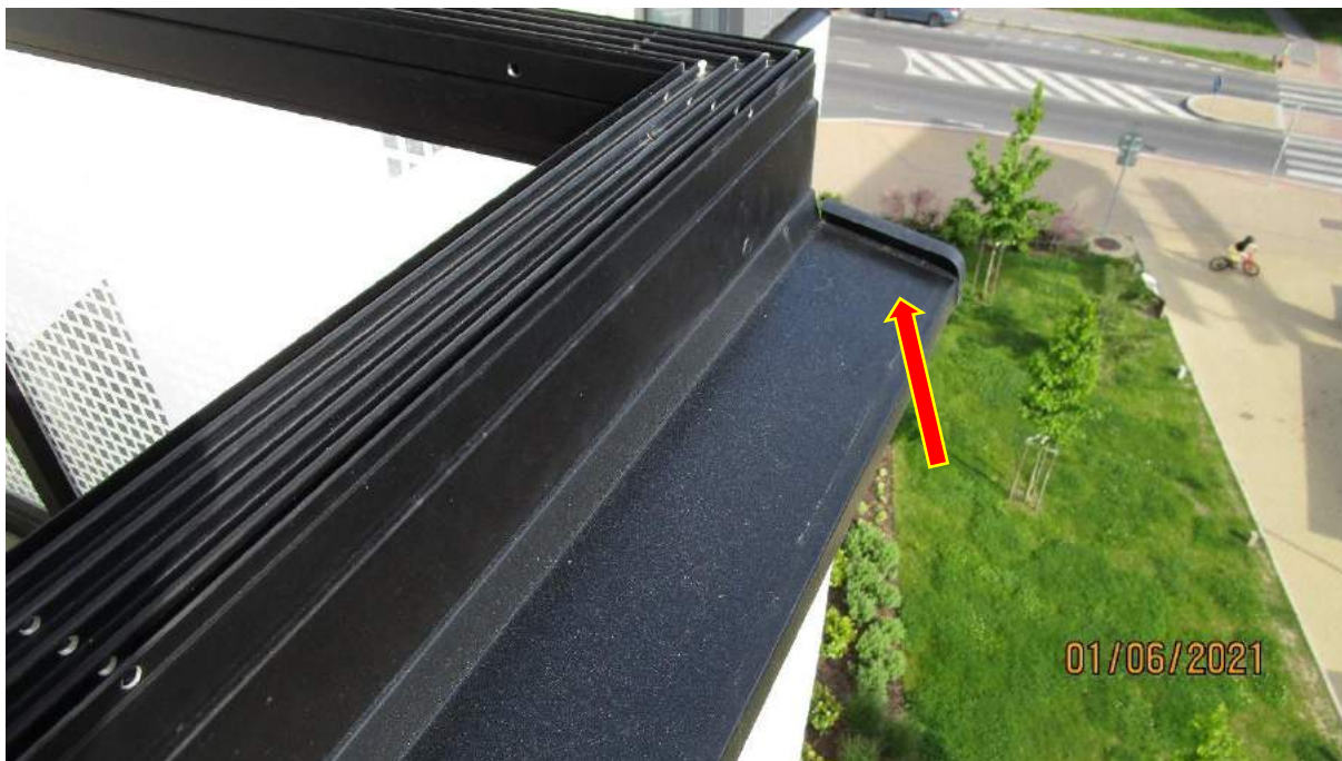
80) parapet nedrží na podkladu
