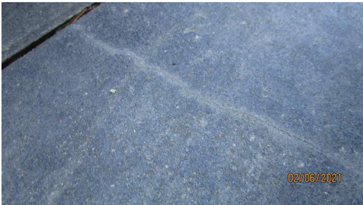
145) dlaždice jsou popraskané
