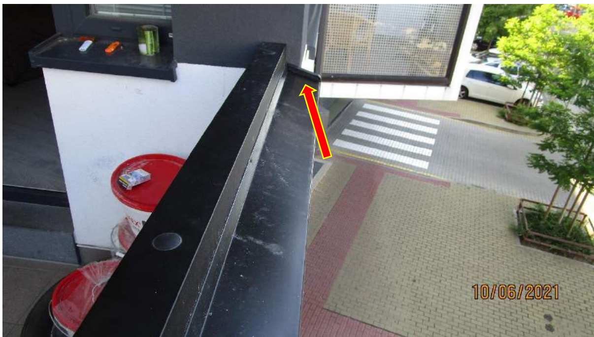
121) parapet nedrží na podkladu
