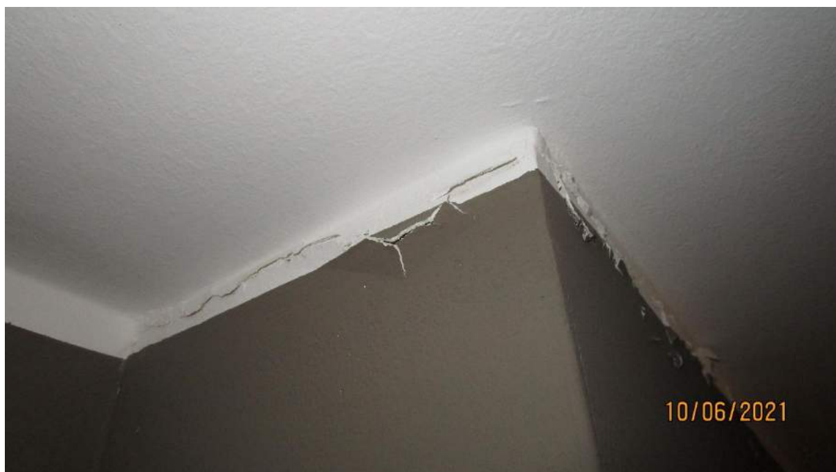
29) prasklina stěny – omítka nadrží na podkladu (zadní schodiště)
