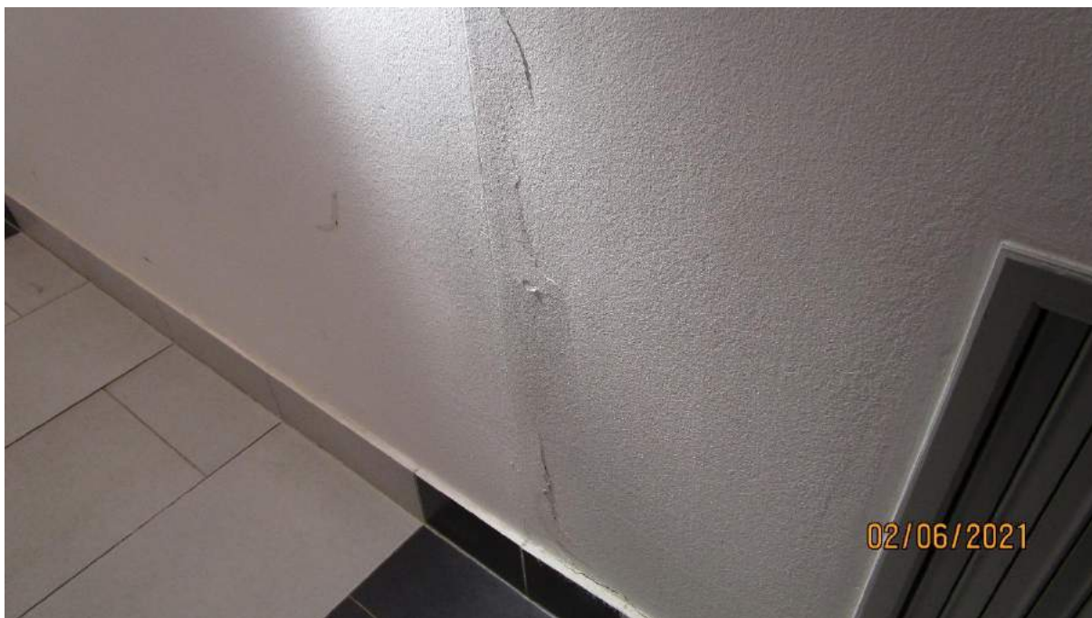
30) prasklina stěny – omítka nedrží na podkladu. Sokl nedrží na podkladu (u bytu 105).
