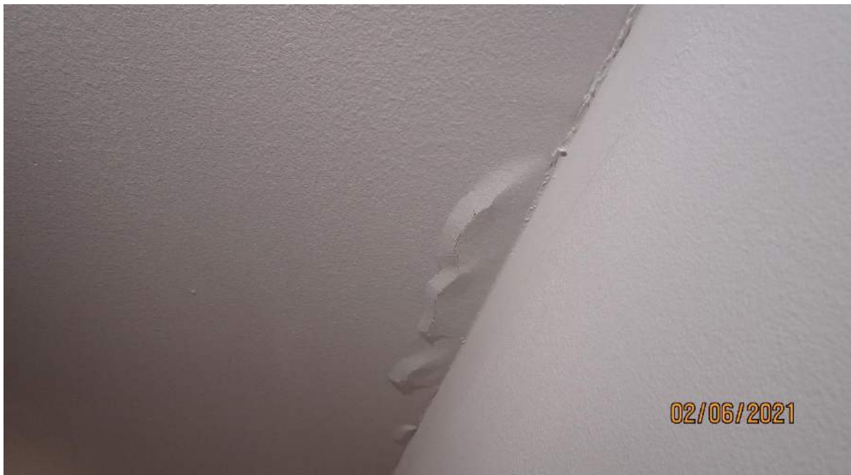
108) prasklina na stropě (u bytu 109)
