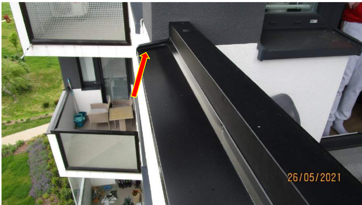
77) parapet nedrží na podkladu
